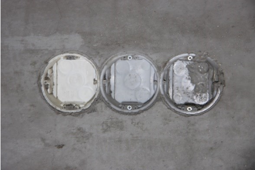
Kuva 6. Sähkörasiointi betonisessa seinäelementissä (Hintikka, 2013)
