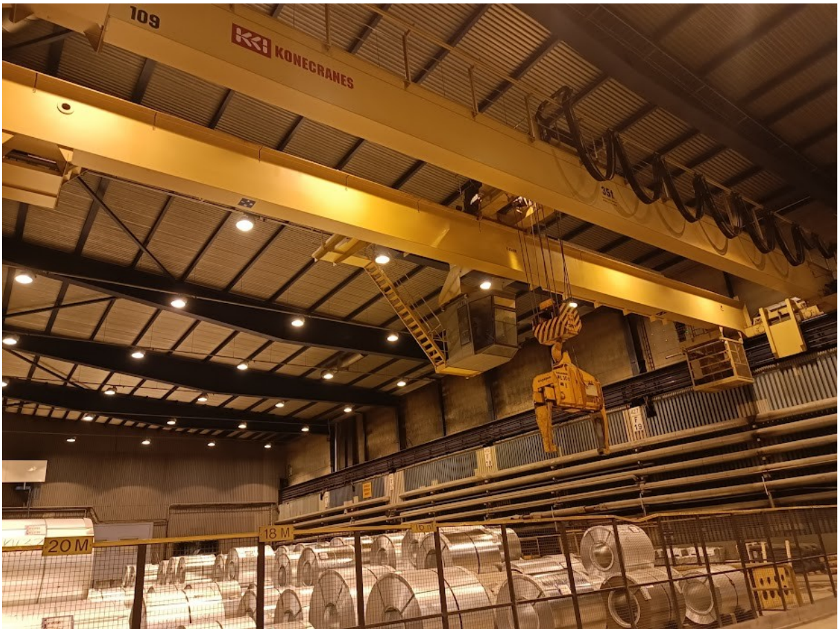
Kuva 4. Siltanosturi (Väistö, M. 2023).
