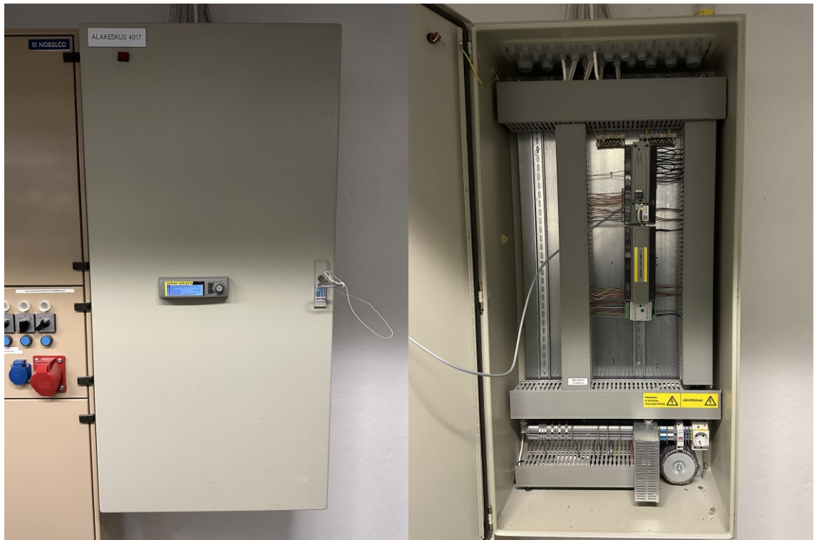
Kuva 11. B-portaan ilmanvaihtokonehuoneen uusittu alakeskus ulko- ja sisäpuolelta
