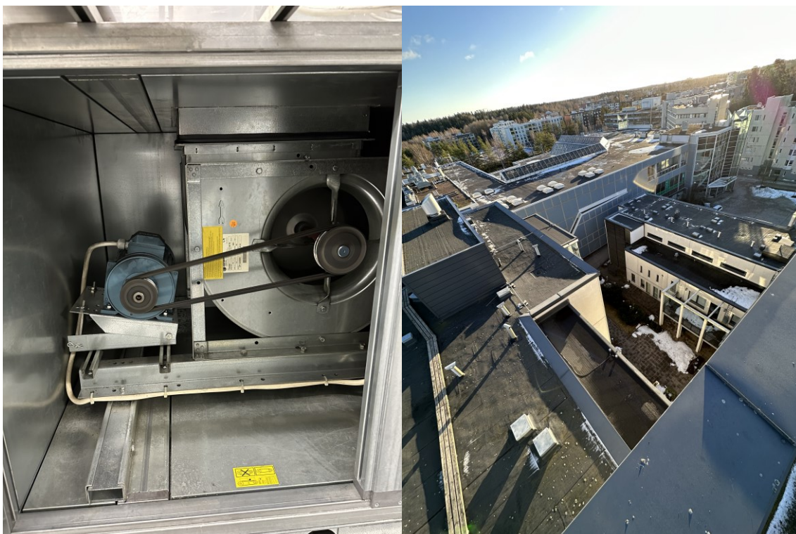
Kuva 29. Vasemmalla kuva B-portaan katolta, josta näkymä A- ja C-portaiden katoille. Oikeanpuoleisessa kuvassa on asuntokohtaisen ilmanvaihtokoneen hihnavetoinen puhallin.
