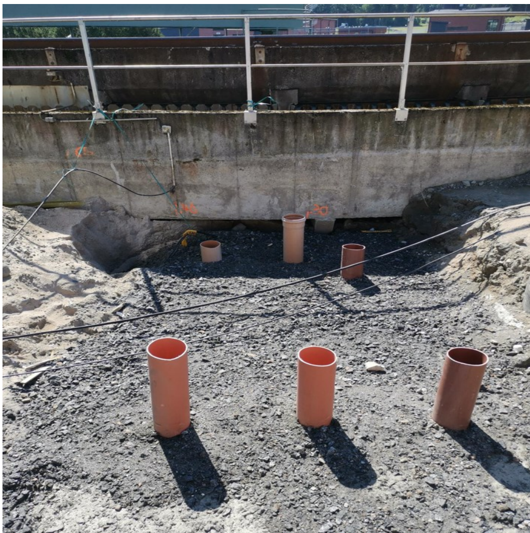
KUVA 4. Paalujen PVC-suojaputket. RR140 paalut lyötiin suojaputkiin, että ne eivät rikkoneet kuvassa 3 näkyviä maanalaisia rakenteita. Kuvassa näkyy myös 2 ylimääräistä suojaputkea, joilla varauduttiin paalun jäämiseen kiveen tai että paalu ei täytä vaatimusta. (Turunen 2022.)
