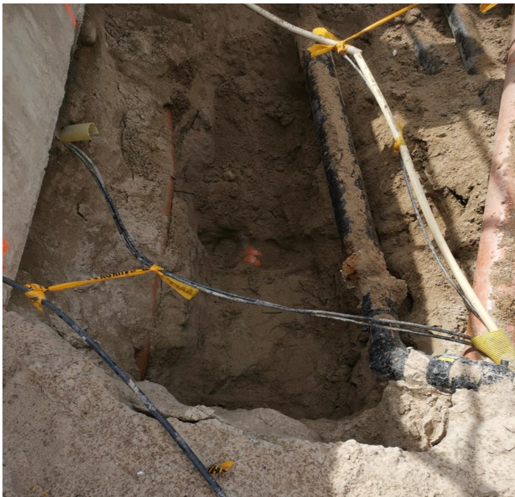
KUVA 3. Maanalaisia rakenteita toteutettavan anturan kohdalla. Kuvassa näkyy viisi putkea ja kolme kaapelia. (Turunen 2022.)
