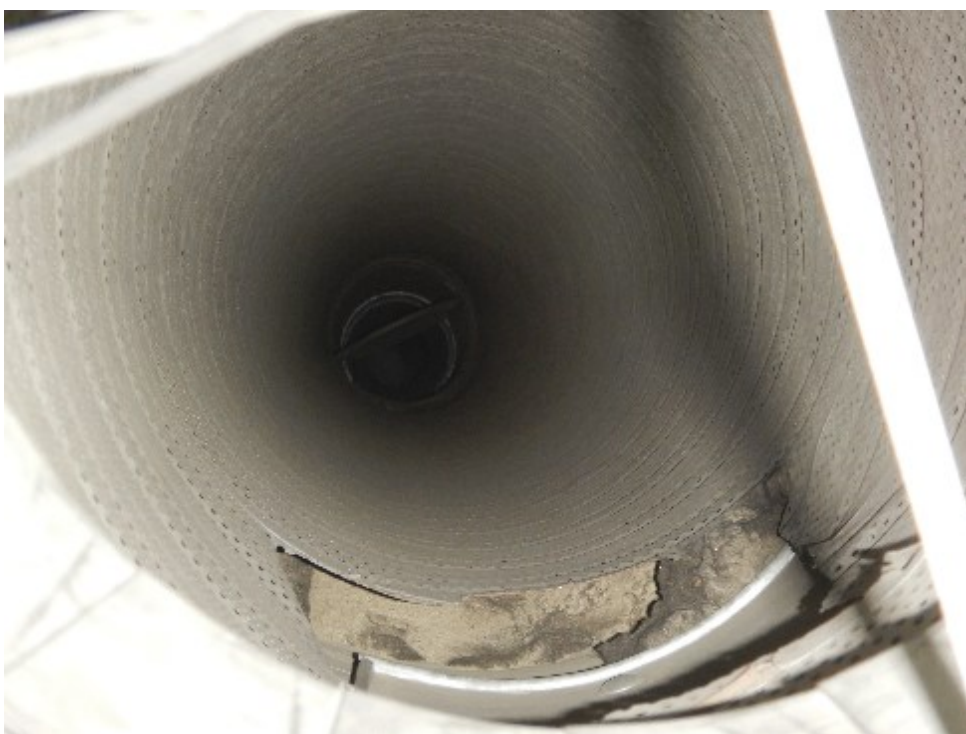
Kuva 13. Palo- ja äänieristetty kanava hajonnut
