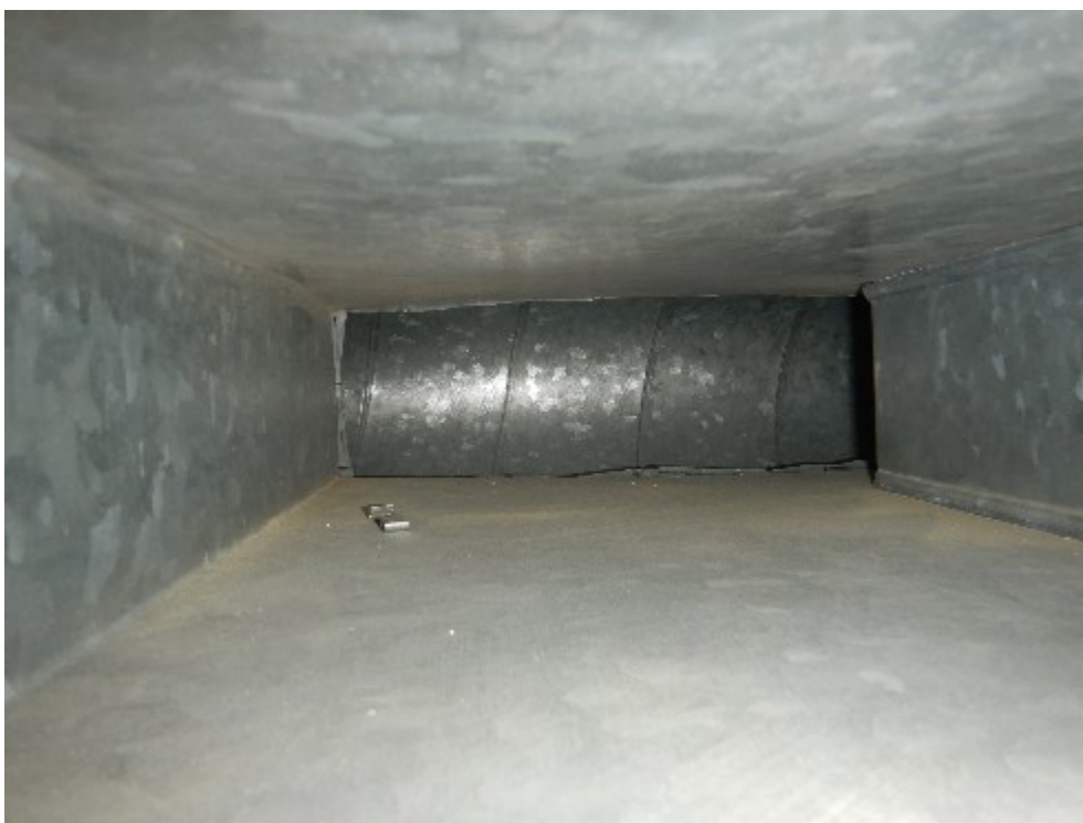
Kuva 22. Likaa tuloilmaventtiilissä / kanavassa
