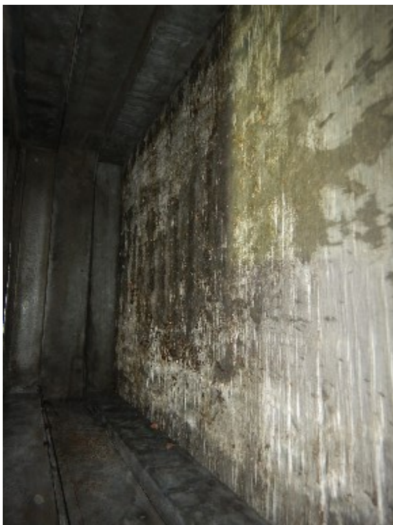
Kuva 8. Lämmityspatteri tukossa ja kolhuilla
