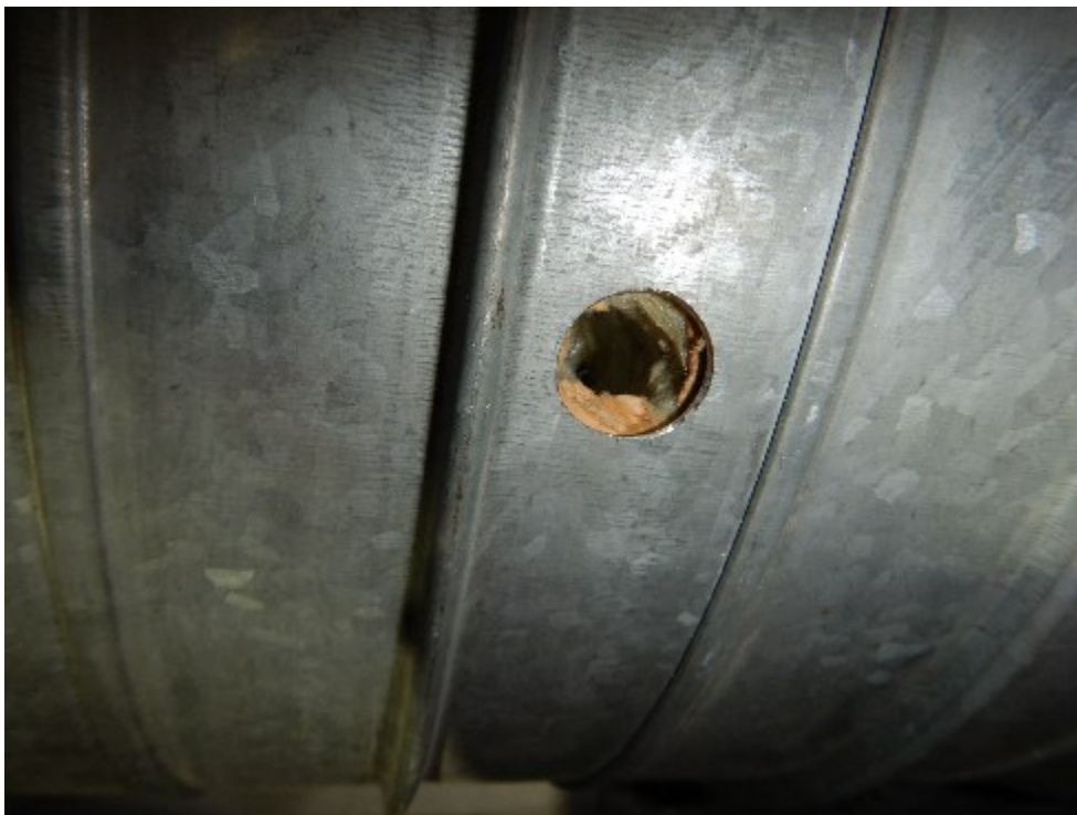
Kuva 16. Tulppaamaton mittareikä ja mineraalivillaa
