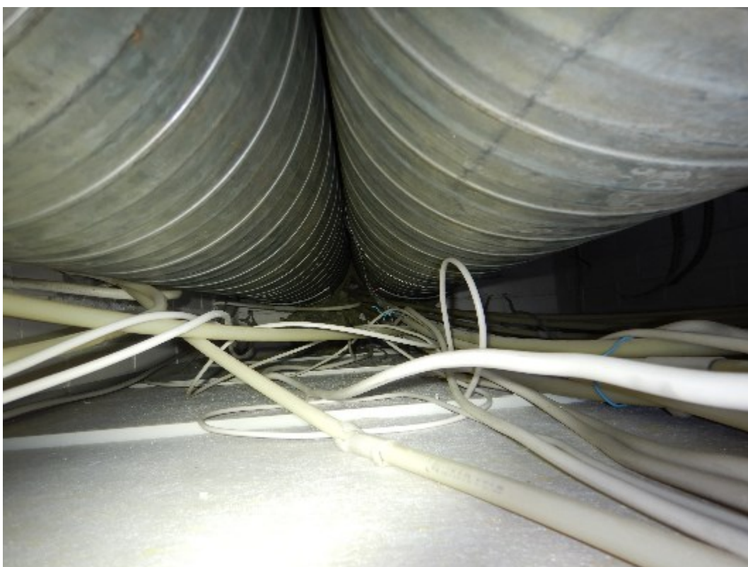
Kuva 19. Alakaton päällä, kuvassa takana ja kanavien alla villaa
