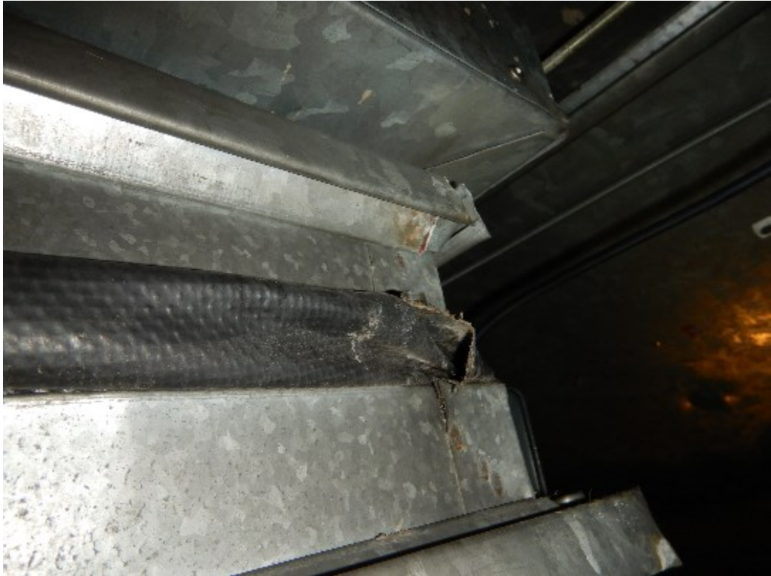
Kuva 6. Raitisilmakanavan ja koneen yhdistävä rähti rispaantunut
