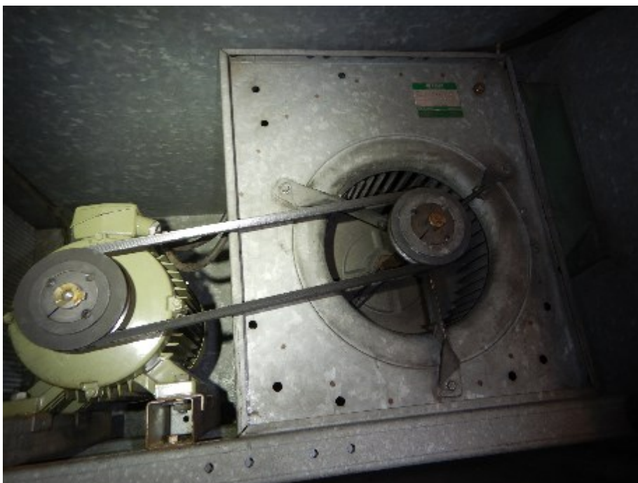
Kuva 9. Puhallinkammio ja puhallin
