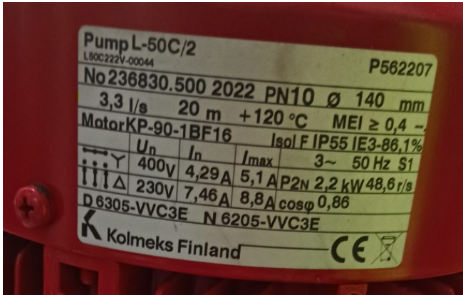
Kuva 13. Tyhjennuspumppu kolmosen tyyppikilpi (Alapiha, 2022).
