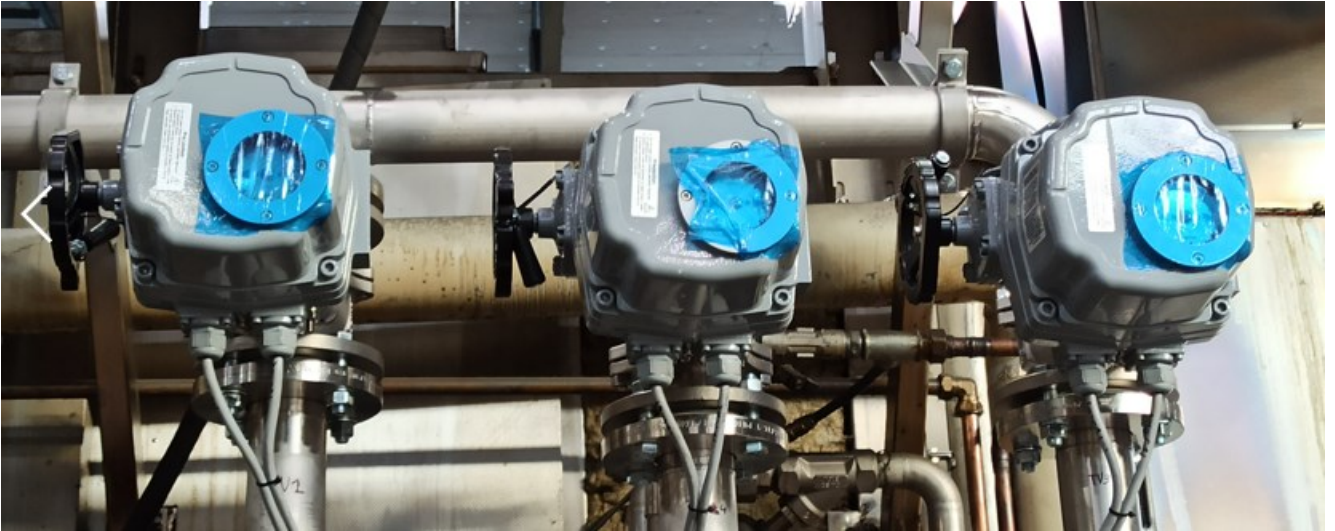
Kuva 9. HKC HQ-015 -sulkuventtiilit TV1, TV2 ja TV3 (Alapiha, 2022).
