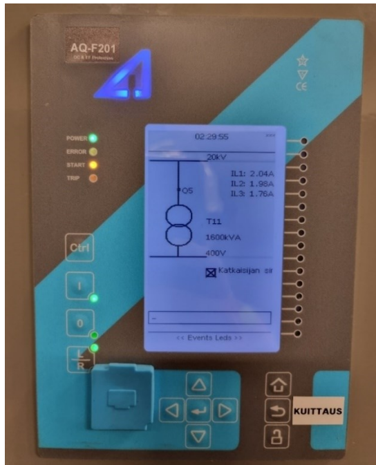
Kuva 16. Tehtaan yksi Arcteq AQ-F201-suojareleistä (Arcteq s.a)
