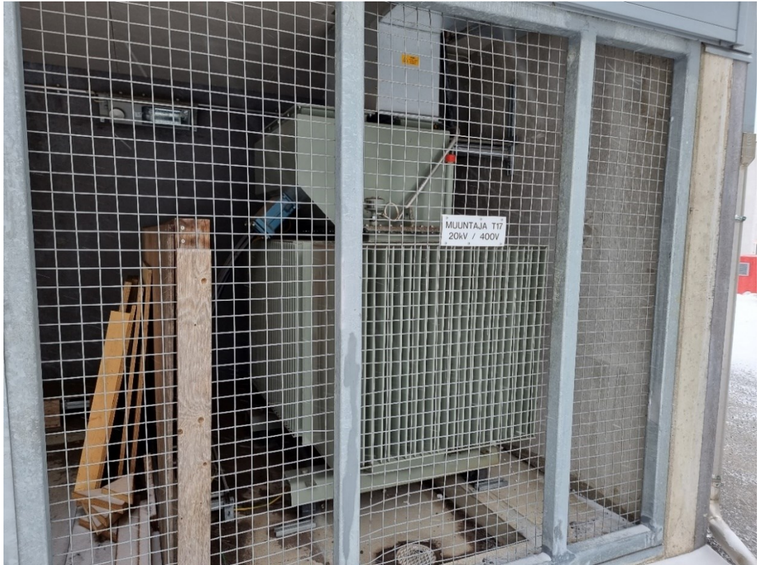
Kuva 8. 20 kV / 400 V kuivamuuntaja
