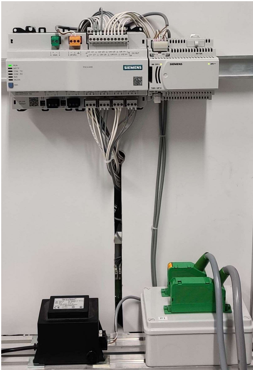
Kuva 9. PLC-taulu takaa ennen revisiota.
