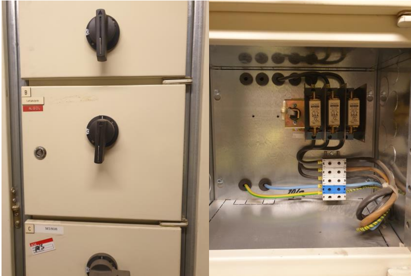
KUVA 68. Pääkeskuksen syöttävä kenno.
