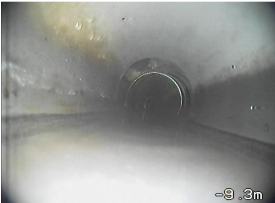
Kuva 5. C-talon runkoviemärissä lievää padotusta.
