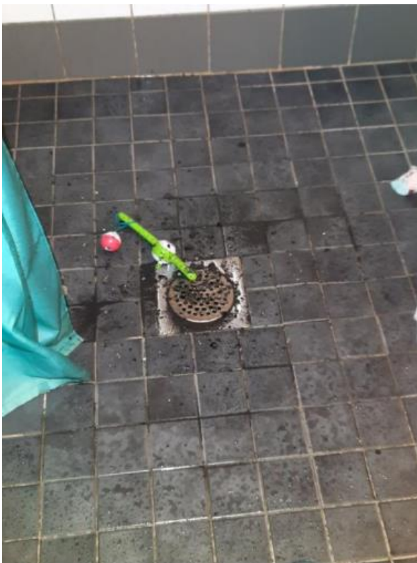
Kuva 10. Lattiakaivosta roiskunut likavesi.
