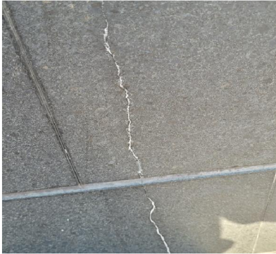
Kuva17.Halkeama toimii reittinä rakenteen laajamittaiselle vaurioitumiselle
