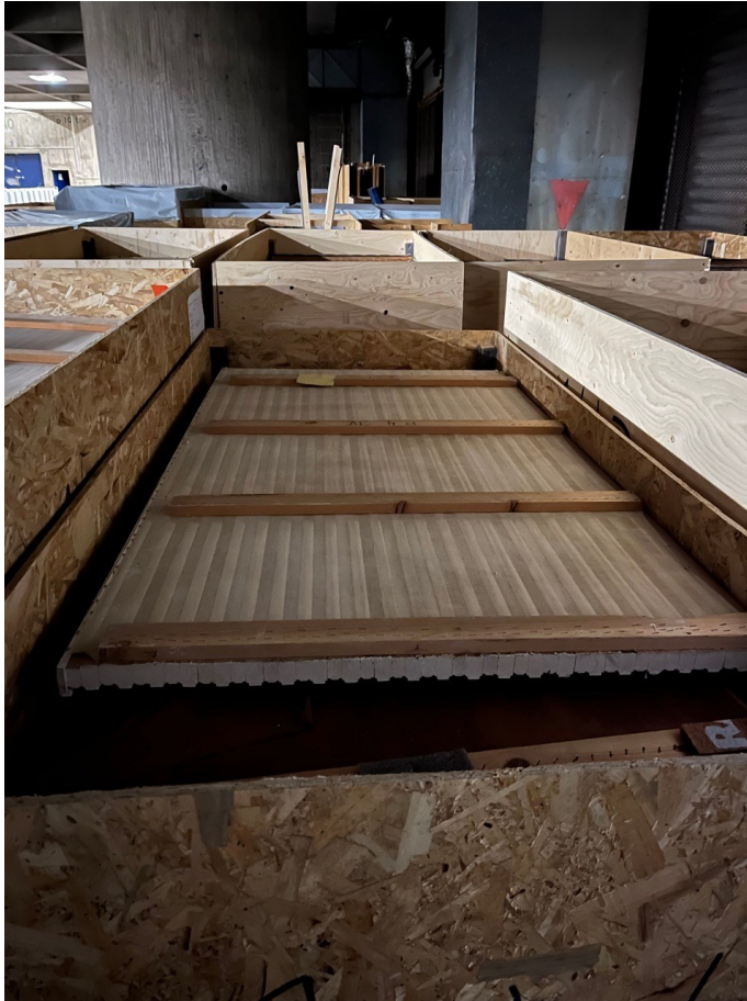
Kuva 21. Varastoituja haitta-ainetöinä irrotettuja puisia alakattoelementtejä.
