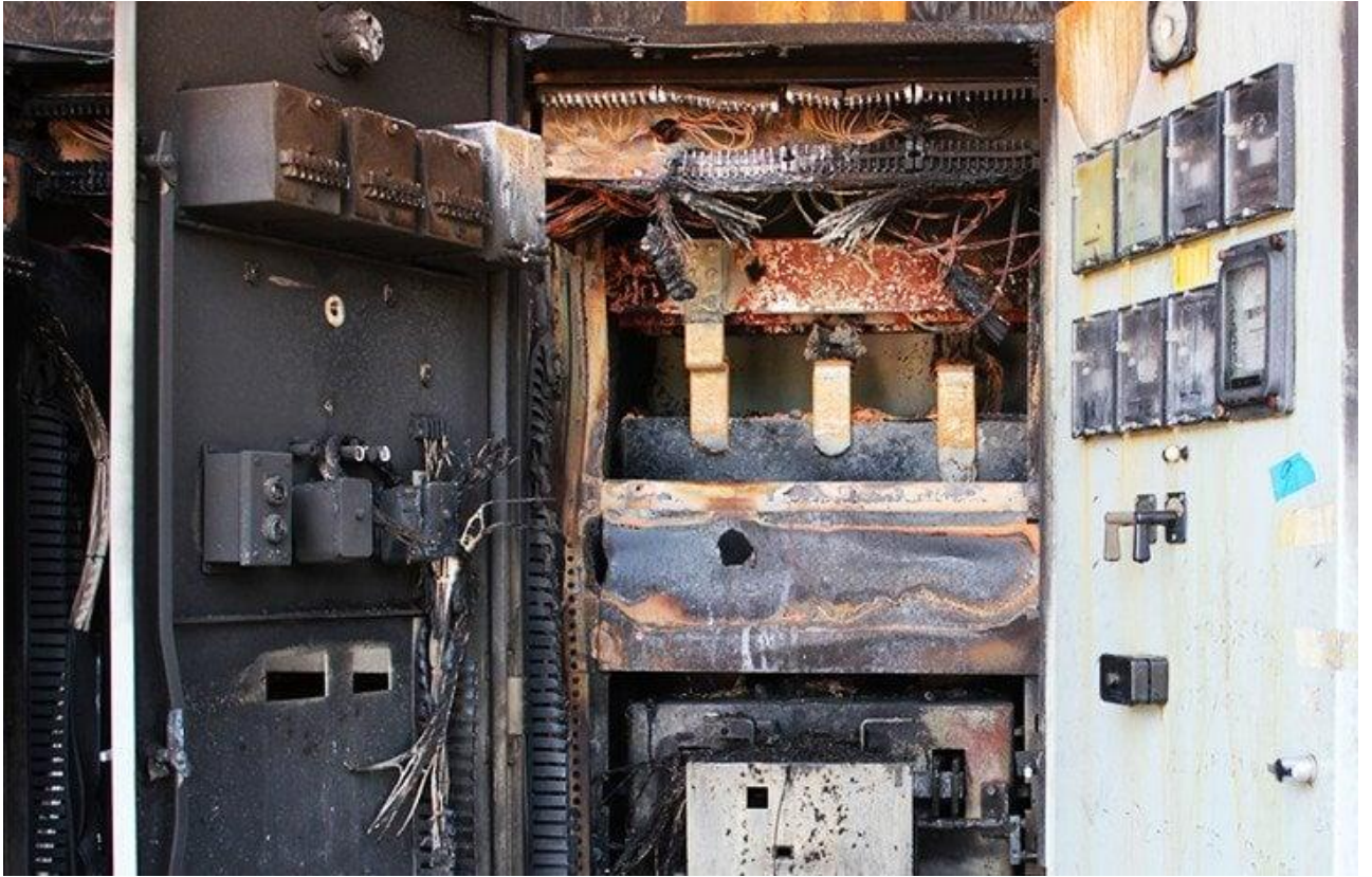
KUVA 1. Valokaaren aiheuttamia vaurioita pienjännitekeskuksessa (7)
