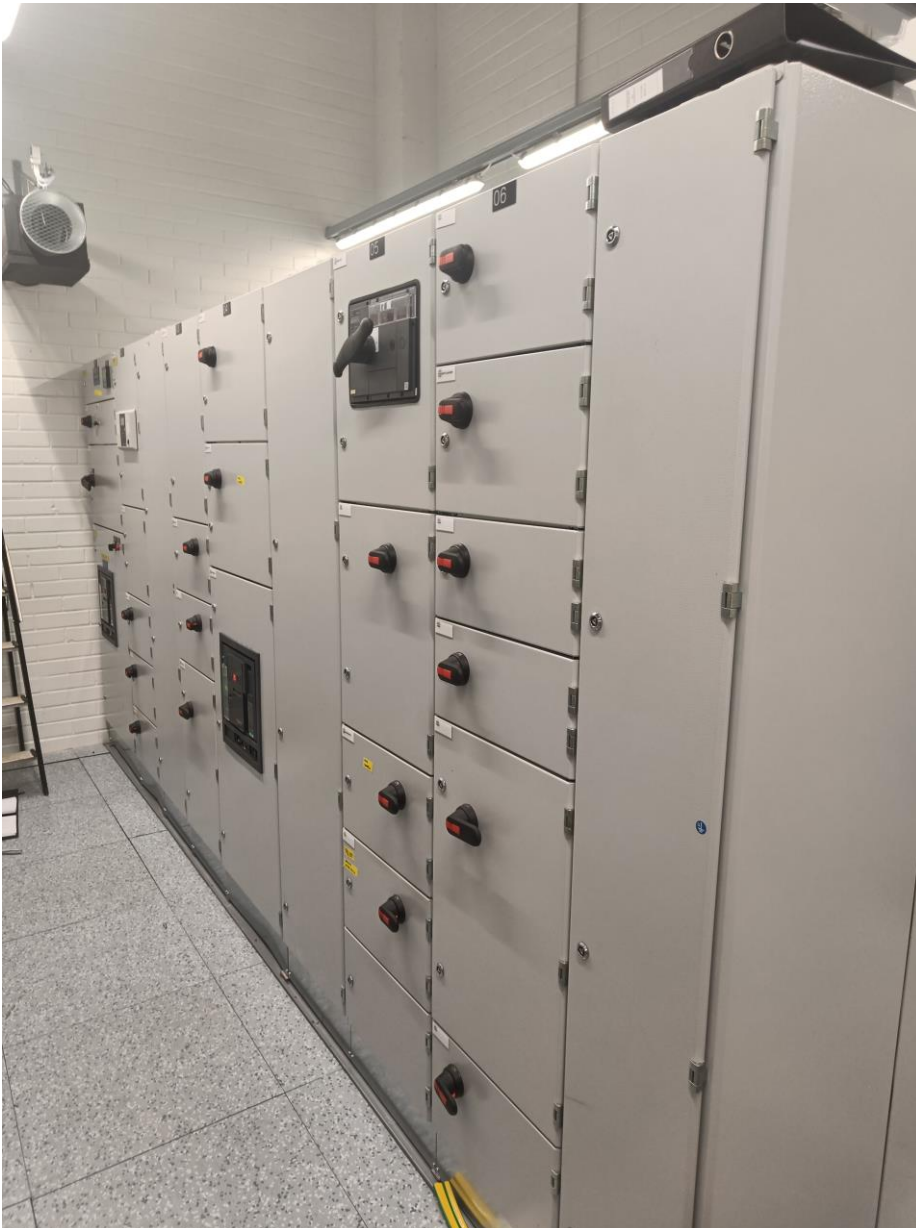
KUVA 10. Uusi pääkeskus PK1
