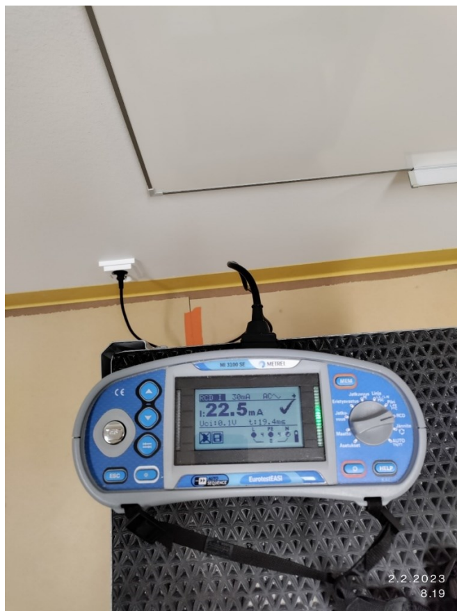
KUVA 11 Pistorasiyhmän vikavirtasuojakytkimen toiminnan mittaus (Väyrynen, 2023).
