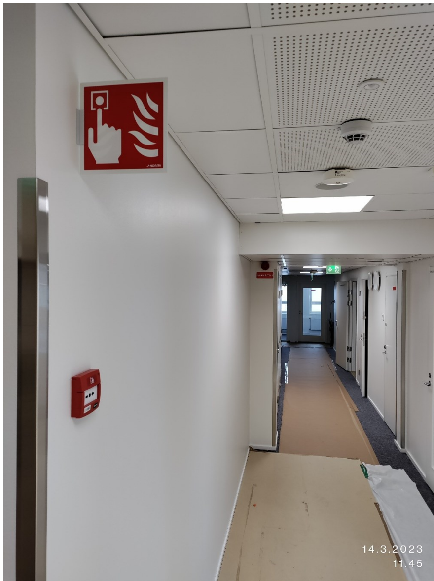
KUVA 18 Etualalla palopainikkeen erilliskyltti, taustalla seinällä palokello ja sen erilliskyltti (Väyrynen, 2023).
