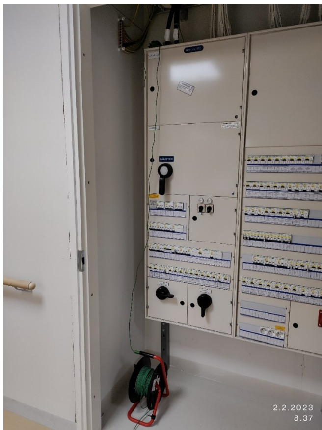
KUVA 7 Apujohdinkela kytkettynä jakokeskuksen yläpuolella olevaan maadoituskiskoon (Väyrynen, 2023).
