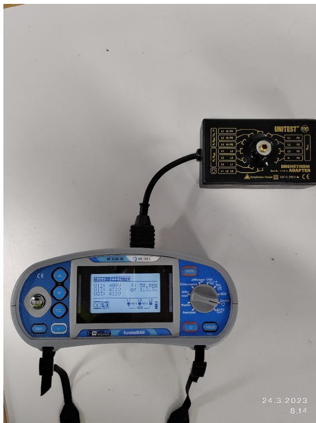
KUVA 12 Kolmivaiheisen pistorasian pyörimissuunnan tarkastus; vaihejärjestys näytön oikeassa reunassa (1. 2. 3.). Mittarissa kiinni kolmivaihepistorasian mittauksessa käytettävä adapteri.
