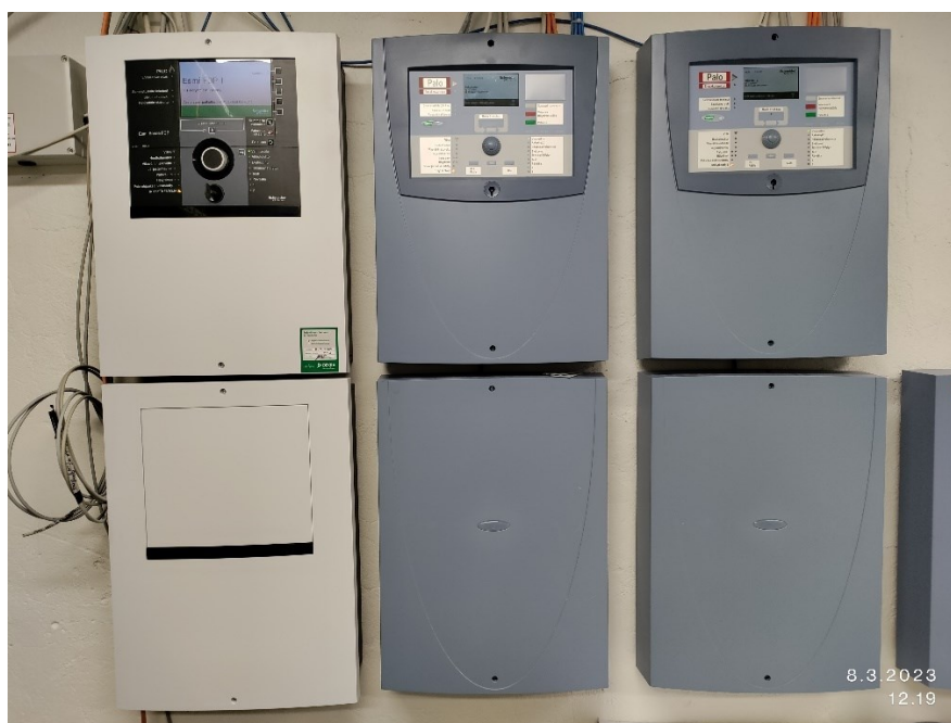
KUVA 15 Kohteen paloilmoitinkeskukset, vasemmalla tämän saneerauksen yhteydessä lisätty Esmi FDP (Väyrynen, 2023).
