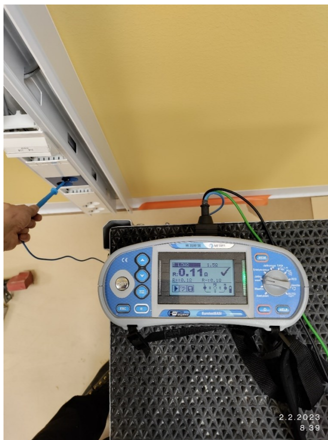
KUVA 8 Erään pistorasian jatkuvuusmittauksen tulos (Väyrynen, 2023).
