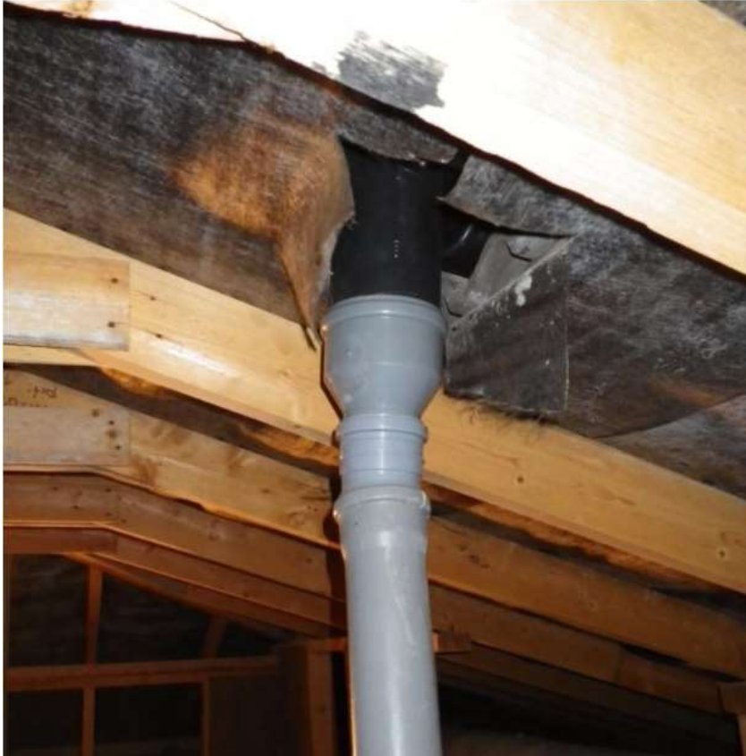
Kuvio 9. Puutteellinen läpivienti yläpohjatilassa (Raksystems 2020)
