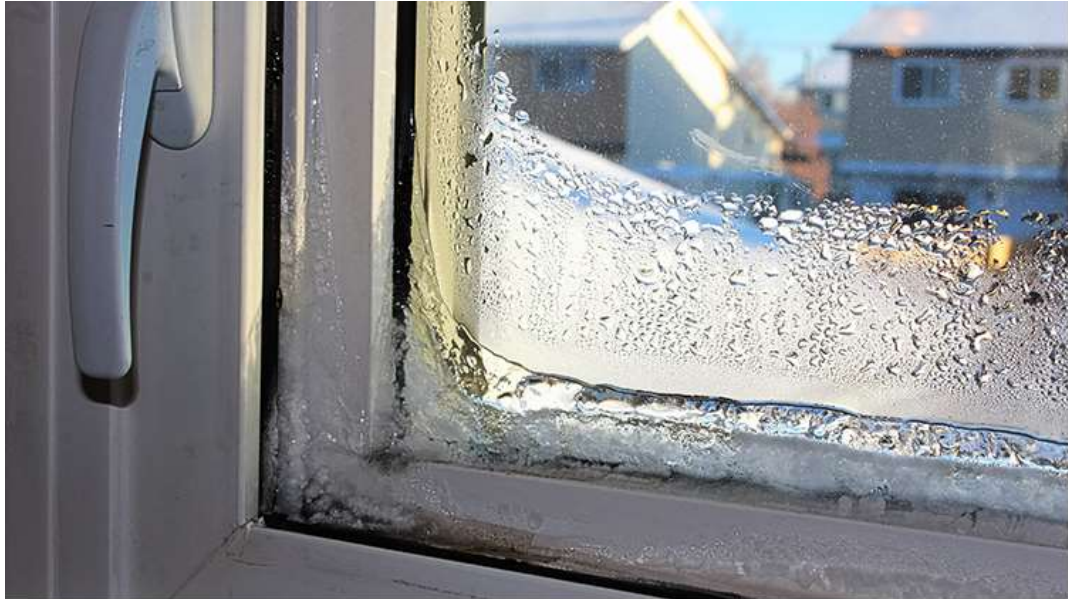
Kuvio 8. Lämpövuoto/puutteellinen ilmanvaihto (rakentaja.fi 2021)
