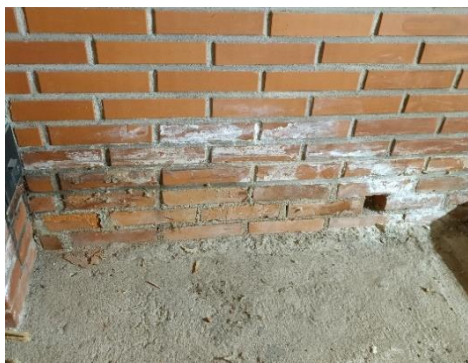
KUVA 6. Kosteusvauriota seinässä ja lattiassa
