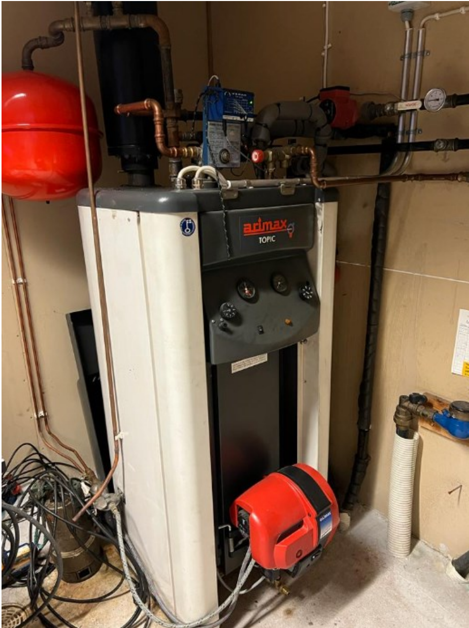
KUVA 6. Uudemman kohteen nykyinen öljylämmitysjärjestelmä
