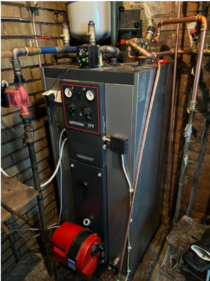
KUVA 4. Vanhemman kohteen nykyinen öljylämmitysjärjestelmä
