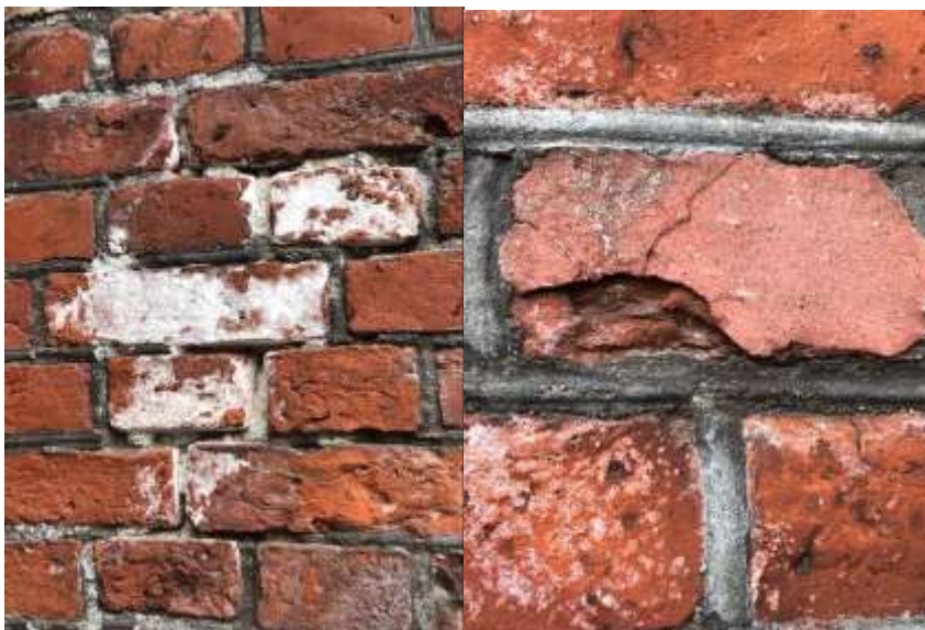
Kuva 13. Ulkoseinien vaurioituneita tiiliä
