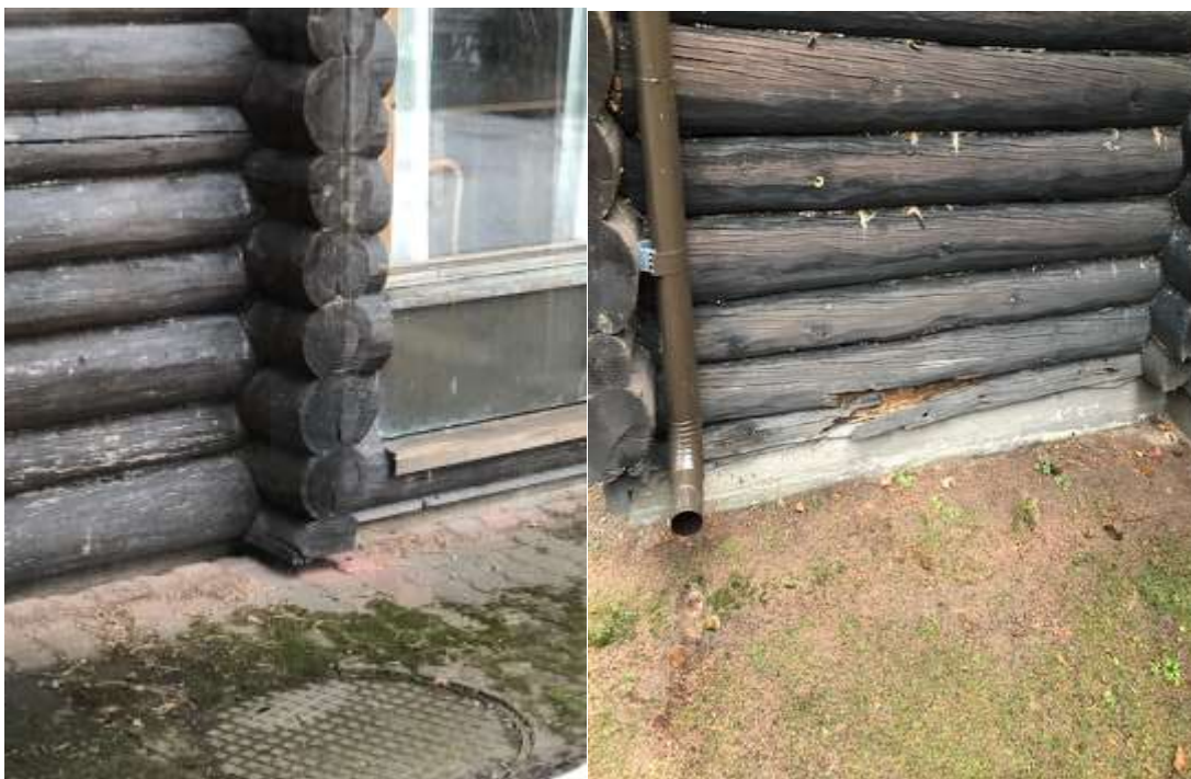
Kuvat 29. Höyterin huonokuntoista ulkoseinää ja ikkuna.
