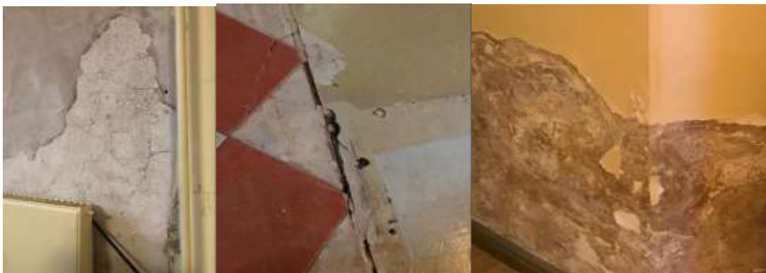
Kuva 11. Sisäseinissä ja lattioissa on näkyvissä vaurioita ja eri aikakausina tehtyjä korjauksia.
