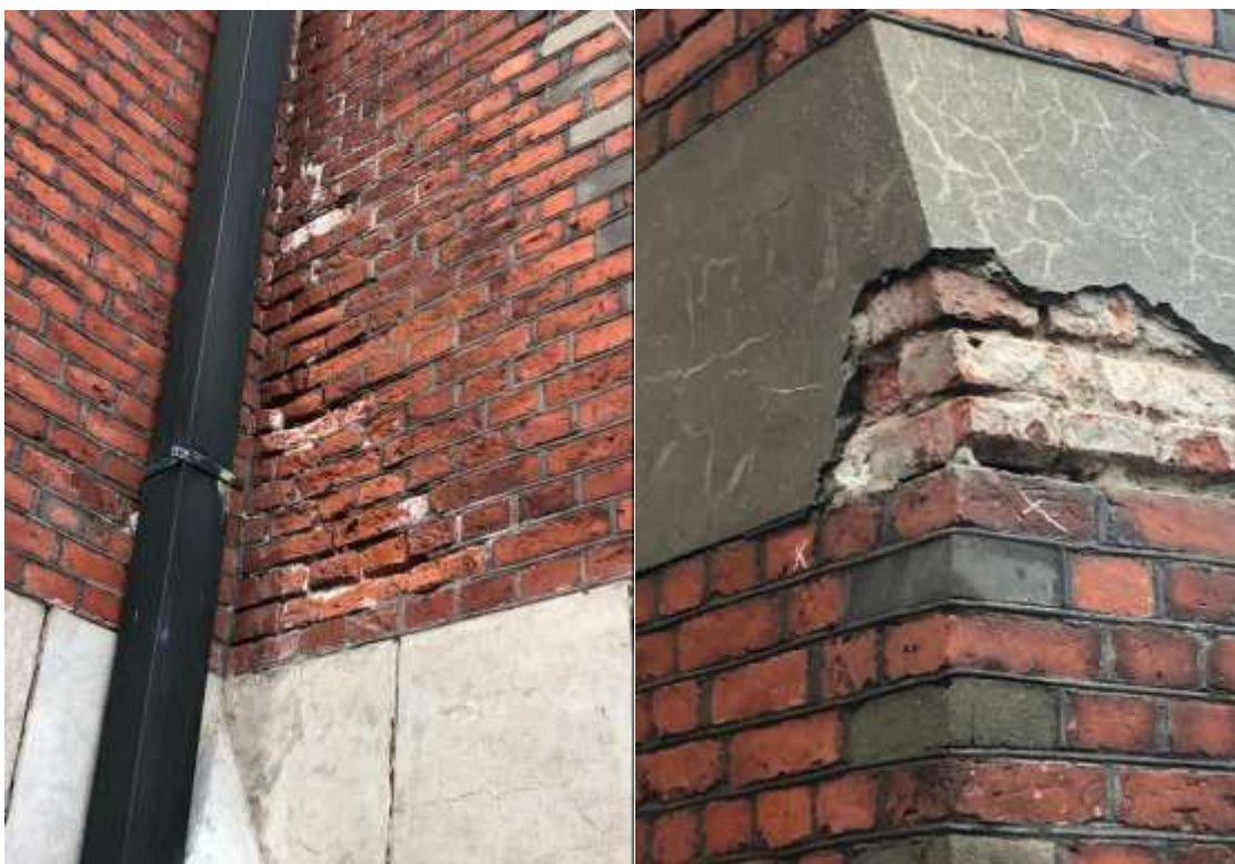
Kuva 14. Julkisivun vaurioituneita tiiliä ja betonisia koristeosia.
