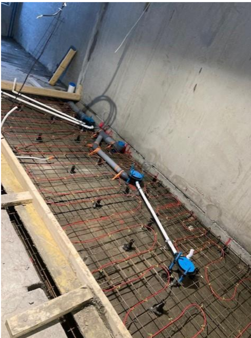
KUVA 4. Kylpyhuoneen lattiaan tehty raudoitukset, viemärihajotukset ja lattialämmityskaapelin asennus. (Arkta Rakennus Oy. Tampereen Auringonpaiste)
