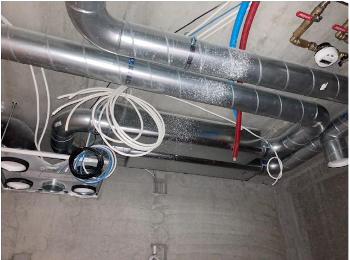
KUVA 5. Kylpyhuoneen kattoon tuotu IV-kanavat, äänenvaimentimet ja asennuslevy IV-laitteelle. Lämmin- ja kylmävesi tuodaan kylpyhuoneeseen kuvissa näkyville PEX-putkilla. (Arkta Rakennus Oy. Tampereen Auringonkukka)
