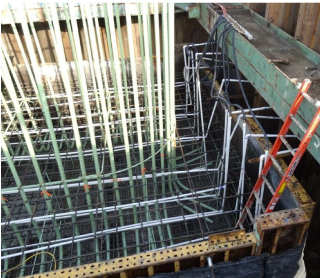
KUVA 8. PVC jäähdtytysputkisto (Shaw 2012, 79).
