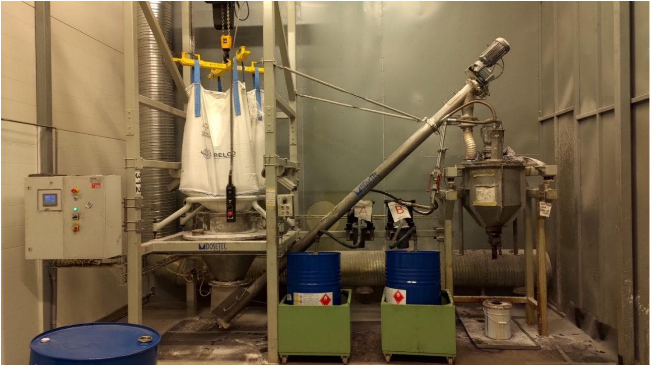
Kuva 3. Hartsinsekoitin. Vasemmassa reunassa hartsinsekoittimen sähkökeskus. Sähkökeskuksesta oikealle valkoinen kvartsihiekkasäkki, keskellä A- ja B-kyllästyshartsikomponenttitynnyrit. Oikeassa reunassa hiekan ja hartsikomponentit sekoittava hartsinsekoitin (Yrittys, 2023).
