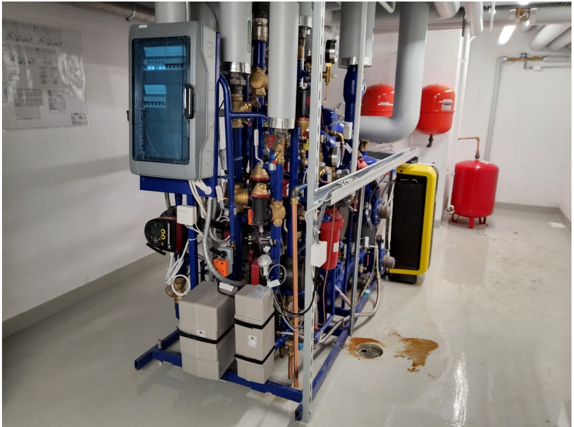
Kuvio 17: Lämmönjakohuone kaukolämmöllä lämpenevässä kohteessa
