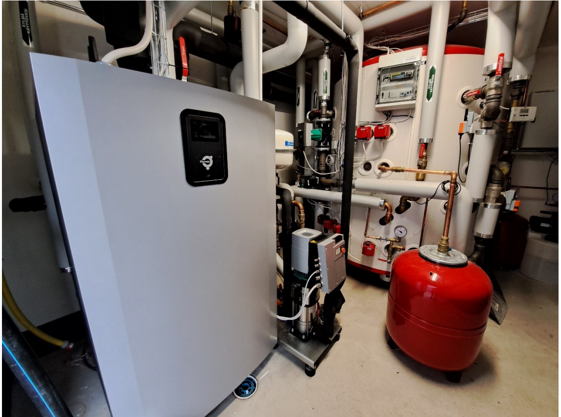
Kuvio 16: Lämmönjakohuone maalämmöllä lämpenevässä kohteessa
