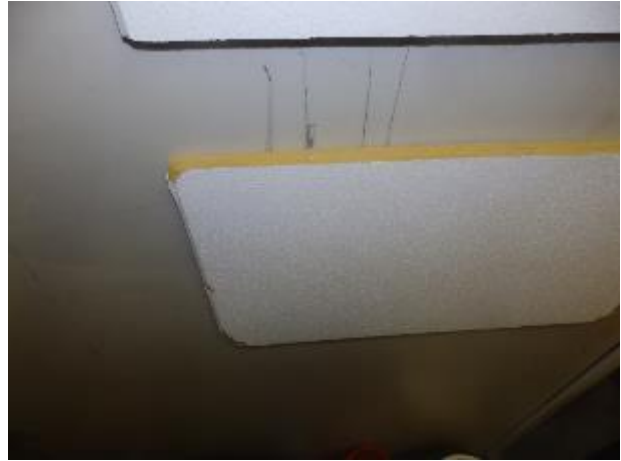
Kuva 44: Tiloissa akustolevyjen pintoja rikki sekä osassa levyjä sivussa villapinta auki, avoimet villapinnat toimivat kuitulähteenä sisäilmaan.
