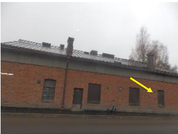
Kuva 11: Reunimmainen ikkuna on Tarkkaamotilan seinän kohdalla, joka sisäpuolelta levytetty. Samalle seinustalle tehdyssä rakenneavauksessa voimakas ilmavirtaus sisälle. Lämpökuvassa (kuva 13) myös hahmottuu ikkunan kohta seinälevytyksen takana.
