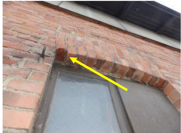
Kuva 16: Ikkuna-aukon yläreunassa olevissa tiilissä ja saumoissa havaittiin rapautumista, josta tiiliä riski pudota alas. Muut rapautumat ovat kosmeettisia ja paikallisia sekä paikantuvat pääasiassa samoille alueille, jossa tehty julkisivuun jotain muutoksia. Kuvan ikkuna on kävelykadun puoleisella sivulla.
