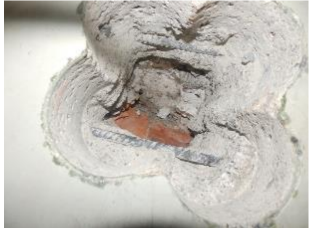
Kuva 6: Tilan 022 kylmiöeteinen kynnyks. Rakennearvauksessa selvisi, että kylmäkatkona kynnyksen kohdalla on pystyeriste 50 mm EPS. Lattian valu on asennettu vanhan ulkoseinän alaosan päälle, kuvassa näkyy tiiltä, joka on vanhaa ulkoseinää. Tiilen vierellä näkyy pystyeriste. Avausta ei laajennettu. Eriste on kuiva.
