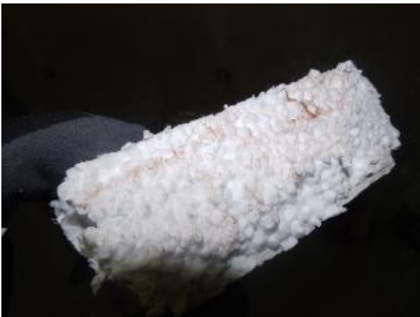
Kuva 33: 020 rumputila väliseinän EPS eristyksessä värjäytymistä ja poikkeavaa hajua.
