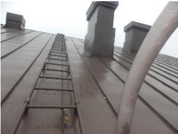
Kuva 51: Kuvattu alkukatselmuksessa 26.10.2022. Vesikaton yläpuolista tarkastelua ei suoritettu tarkemmin, kun olisi vaatinut nostimen käytön liukastumisriskin takia. Vesikatto maalattu 2021?
