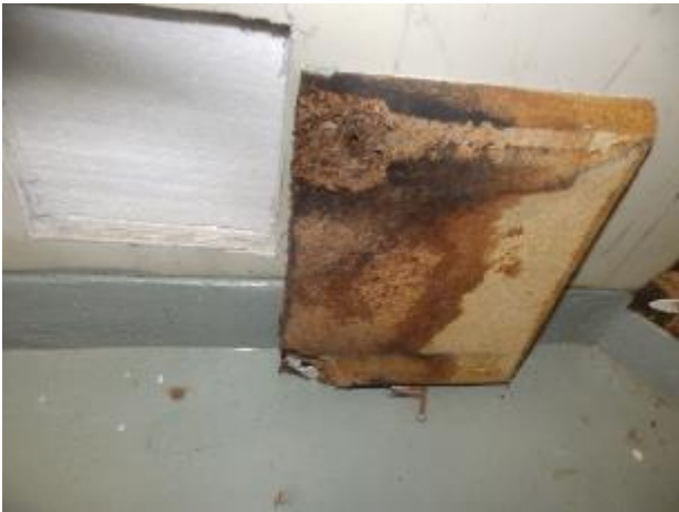
Kuva 35: 020 rumputila viemärin tarkastusluukun edessä olevan luukun vaurioitunut takapinta. Vaurio viittaa pidempiaikaiseen kosteusrasitukseen.
