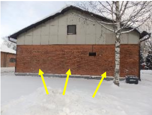
Kuva 9: Päädyssä näkyy 3 ummistettua aukkoa seinässä, lämpökameratarkastelun (kuva 10) perusteella epäily, ettei aukkojen ummistamista ole tehty lämpöteknisesti toimivaksi.
