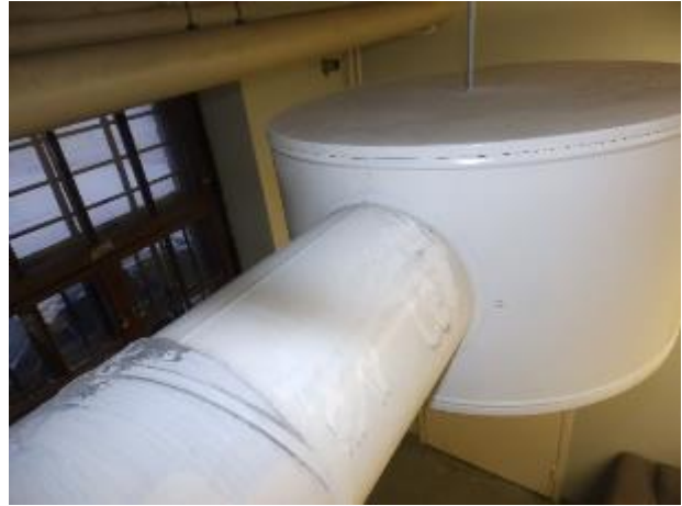
Kuva 81: Ilmanvaihtoputkien päällä ja muissa korkealla olevilla tasojen pinnoilla oli runsaasti pölyä pistokoemaisesti tehdyssä tarkastelussa. Kerääntyneellä pölyllä riski kulkeutua hengitysilmään.
