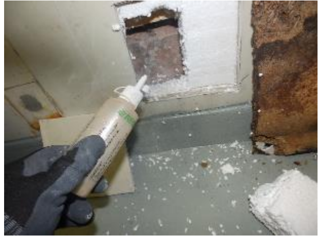
Kuva 32: Tilassa 020 rumputila väliseinässä levytyksen takana koolaus ja EPS eristys 50 mm. Seinän avauskohdasta voimakas ilmavirta sisälle päin merkittävä tarkasteltuna. Eristeen takana kantava tiiliseinä. Tilassa poikkeuksellinen hajua.
