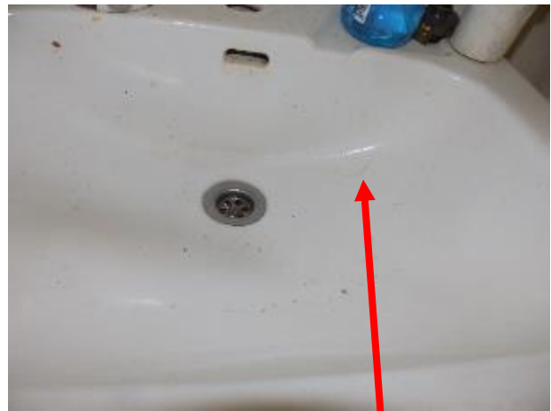
Kuva 90: Tarkastettiin vesikalusteiden kunto aistinvaraisesti. Tilassa 008 wc, havaittiin pesualtaassa halkeama. Halkeama ei ole läpi eikä allas vuoda.
