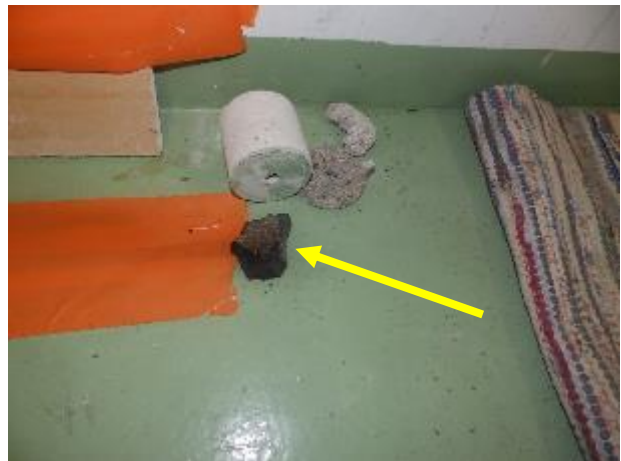
Kuva 8: Kuvassa näkyy lattiarakenteessa osassa tiloja esiintynyttä mustaa kerrosta, jonka haitta-aineasiantuntija arvioi olevan valuasfalttia. Tuotteessa oli vahva öljymäinen haju aistinvaraisesti tarkasteltuna. Hajua ei havaittu tutkimusten yhteydessä huonetiloissa.
