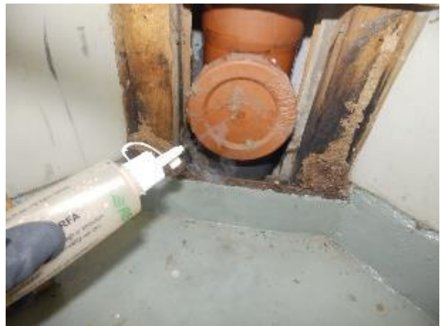
Kuva 34: Tilassa 020 rumputila on viemärin tarkastusluukku, jossa luukun levyssä ja puukoolauksissa kosteuden aiheuttamia vaurioita. Välistä voimakas ilmavirta sisälle. Poikkeuksellinen hajua aiheutuu vaurioituneista rakenteista.
