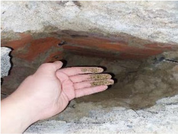
Kuva 1: Puretun kylmiötilan nurkassa hiekkatäyttö oli kuivaa (ei jää palloksi, eikä tartu sormiin), Seinä on kastunut ulkopuolisesta kosteudesta. Yläpuolen leikkauskuvassa (piirros 1) näkyy rakenne.
