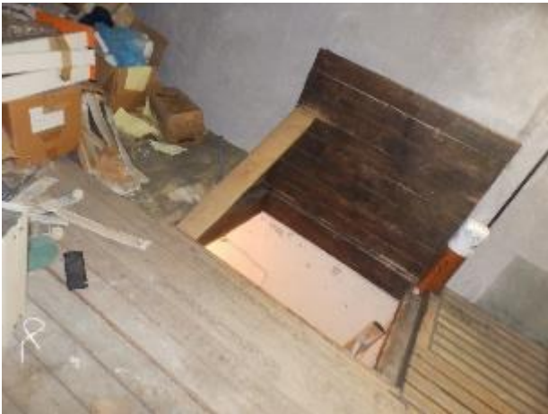
Kuva 29: Ullakkotila on yläpohjaan olevan nousun yhteydessä. Luukku ei ole tiivis, välipohjan eristepinnat osittain auki huoneen ilmatilaan.
