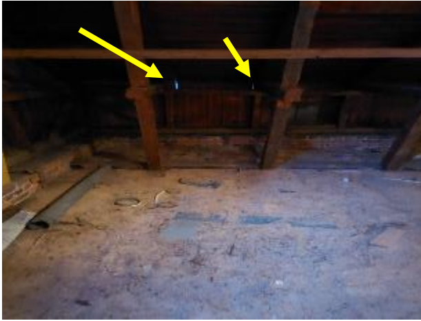
Kuva 57: Yläpohjan tuuletus satunnaisten reikien ja aukkojen kautta, joita on ympäri yläpohjaa.
