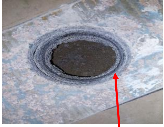
Kuva 2: Rakenneavauskohdassa näkyy tumma kerros valujen välissä, joka haitta-aineasiantuntijan arvion mukaan on valuasfalttia. Kuva on bänditila 4 lattiasta. Hiekka on kuivaa.
