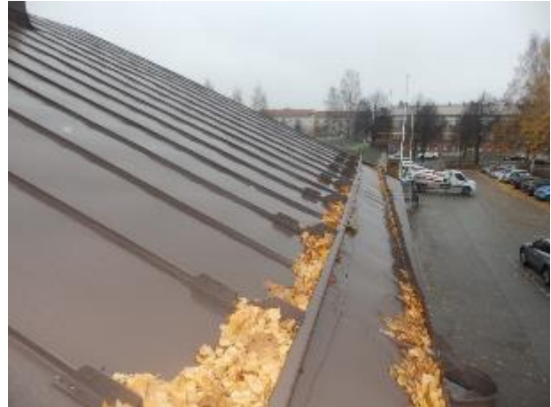
Kuva 67: Katolla on lumiasteet ja pystykourut, jossa kerääntynyt puun lehtiä. Kerääntyvät puunlehdet estävät veden ohjautumista hallitusti. Kuvattu 26.10.2022
