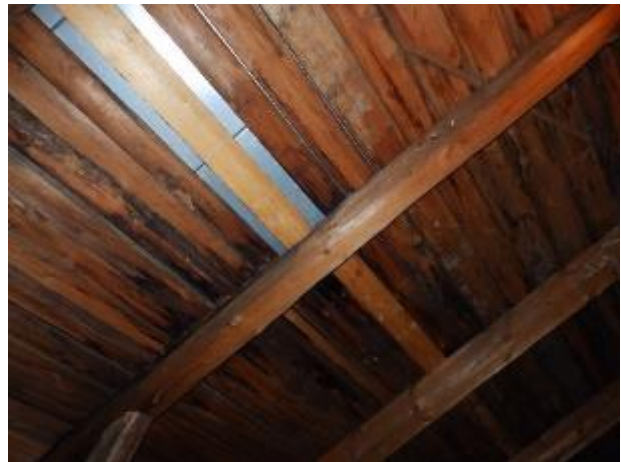
Kuva 52: Paikoin ruodelaudoituksessa on kosteuden aiheuttamia jälkiä, tutkimushetkellä kuiva. Paikoin ruodelautoja on uusittu. Vesikatteen alapinnassa ei havaittu tutkimushetkellä kondenssia.
