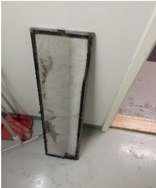
Kuva 73: Tuloilmakoneen suodatinten kohdalla olevan pohjalevyn päällä oli lunta, eriste kastunut.
