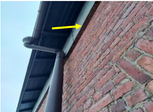
Kuva 59: Edellinen kuva (kuva 56) on otettu julkisivun mineriittilevyn takaa yläpohjan kautta.
