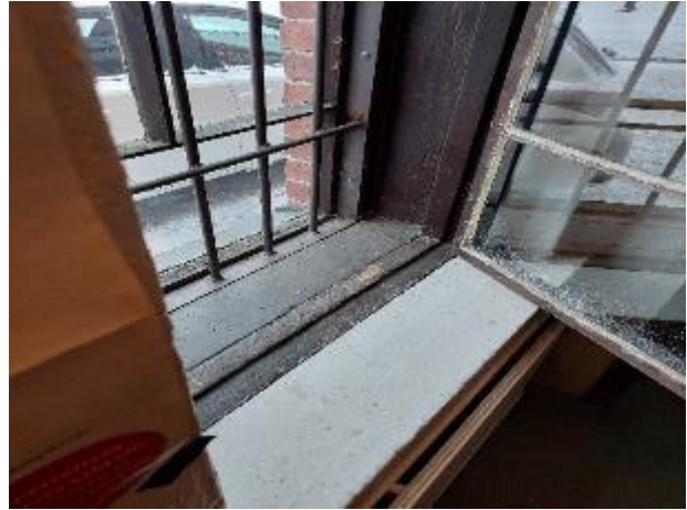
Kuva 22: Ikkunat ovat yksikerroslasilla. Ikkunat eivät ole tiiviitä, ikkunoiden toiminnassa ei havaittu puutteita.
