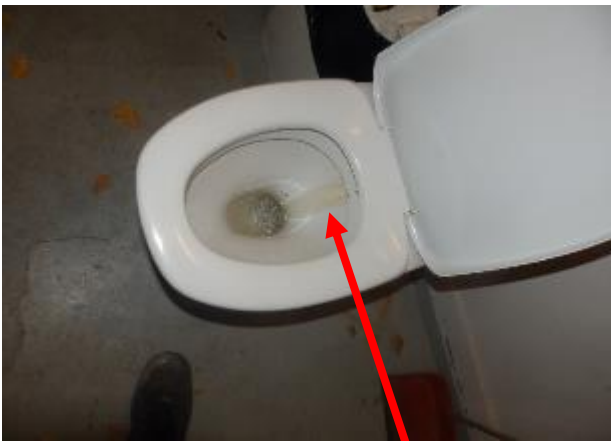
Kuva 93: Wc-pytyn takaseinämässä tumma alue, joka viittaa, että wc-pytty jäänyt vuotamaan läpi. Kylmän veden läpivirtaaminen pytyssä lisää pytyn kondenssiriskiä kesäaikaan. Tutkimushetkellä pytyn läpivuotoa ei havaittu. Kuva on tilasta O10 wc.
