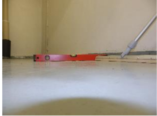
Kuva 88: Tarkastettiin lattiakaivon ympäriltä lattian kaadot vesivaakaa käyttäen. Iv-laitetilassa ja tilassa 010 wc lattian kallistukset puutteelliset kaivon ympärillä. Muissa tiloissa kallistus kaivon ympärillä kunnossa.
