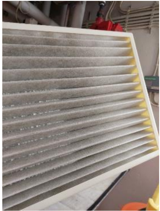
Kuva 72: Tuloilmakoneen suodattimet on vaihdettu alle 2 kuukautta aiemmin. Suodattimiin muodostunut pöly, mutta edelleen siistit.
