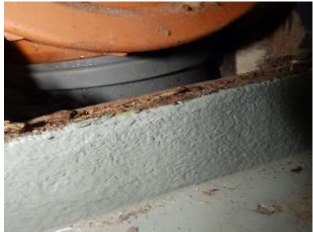
Kuva 36: Tilassa 020 rumputila viemärin tuuletusputken pinnassa nurkkakotelossa kondenssikosteutta.
