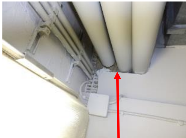
Kuva 38: Iv-laitetila, väliseinän läpivientejä ei ole tiivistetty, villaeristepinnat on näkyvissä, jotka toimivat kuitulähteenä sisäilmalle sekä riskinä epäpuhtauksille huoneilmaan.
