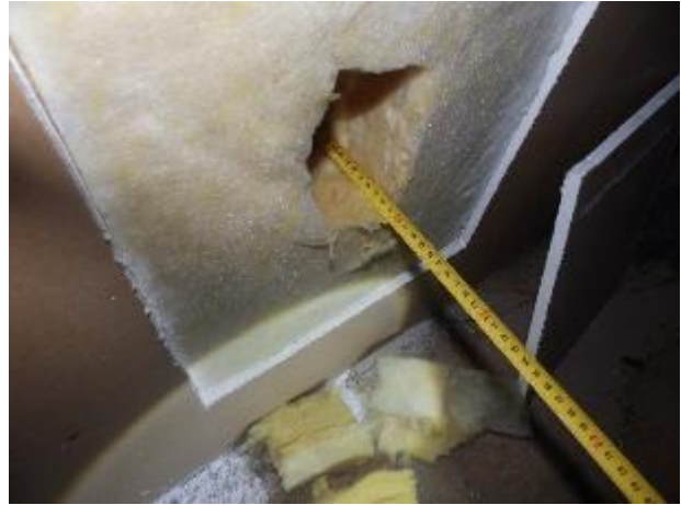
Kuva 40: Lämpökeskuksen seinän rakenneavaus ulkopuolelta tehtynä, välissä on mineraalivillaa (lasivilla) 200 mm, ei havaittu villaeristeissä hajuhaittaa tai kipsilevy-pinnoissa vaurioita rakenneavauskohdalla.
