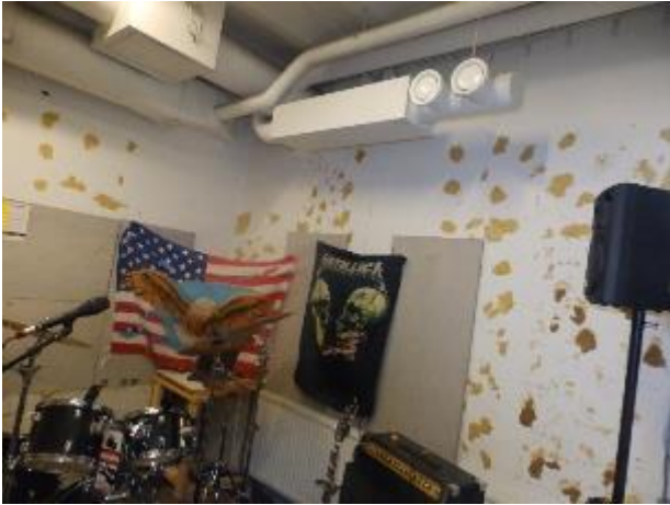
Kuva 43: Bänditila 5 seinän pinnoissa paljon poistettujen akustolevyjen jäämiä.
