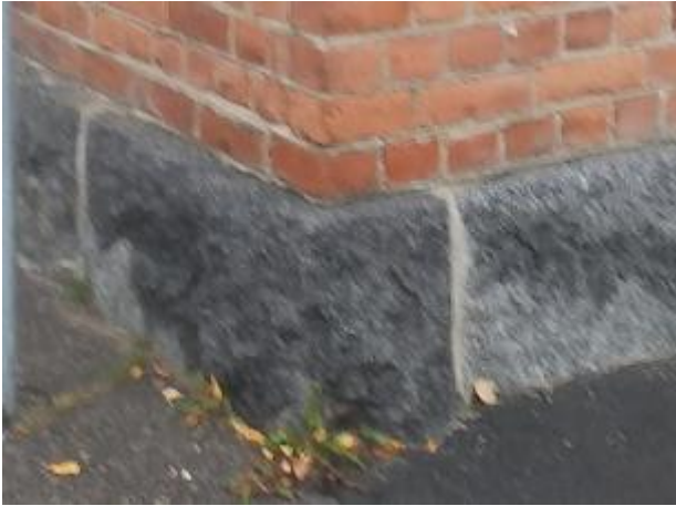
Kuva 17: Kivijalan yläpinta toimii alustana sadevedelle ja lumelle, joka lisää ulkoseinän alaosan kosteusrasitusta. Tiiliseinä jatkuu kivijalan yläpintaa alemmas sisäpuolella. Kivijalassa on valumajälkiä sadevedestä.
