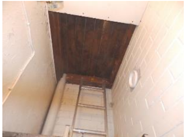
Kuva 30: Yläpohjaan oleva luukku ei ole tiivis. Ullakon portaikossa on erillinen poistoilmaventtiili, jossa ajoittain voimakas imu ja ajoittain imua ei havaittu ollenkaan paperilla tarkasteltuna. (ilmanvaihtokoneiden käyntiajat)
