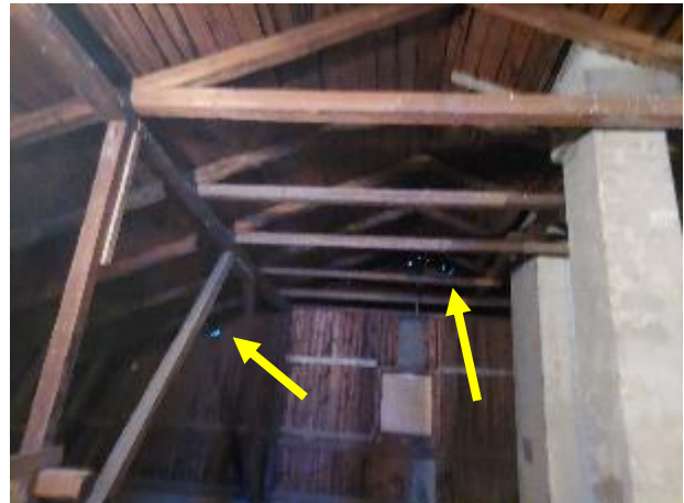
Kuva 60: Yleiskuva yläpohjasta, jossa myös päätyseinustalla näkyy aukkoja ulos.
