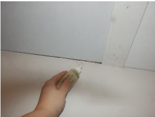
Kuva 45: Alakatoissa on rakoja seinän vierustalla, josta ilmavirtaus sisätilaan päin, todettiin merkisavun avulla. Alaslasketuissa katoissa olevat villaeristeet riski toimia kuitulähteenä sisäilmaan, riski myös toimia lähteenä epäpuhtauksille sisäilmaan.
