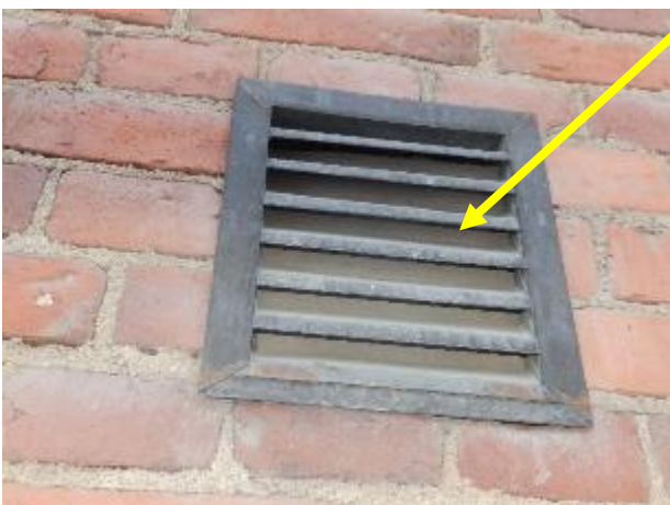
Kuva 28: Ulkoseinässä on vanhoja painovoimaisia venttiileitä, jotka ummistettu sisäpuolelta. Havaittiin venttiilien välissä osittain villaeristeitä, tässä kuvan venttiilissä villaeristeiden edessä on jokin levy ei tarkentunut aistinvaraisesti tarkasteltuna mikä levy.
