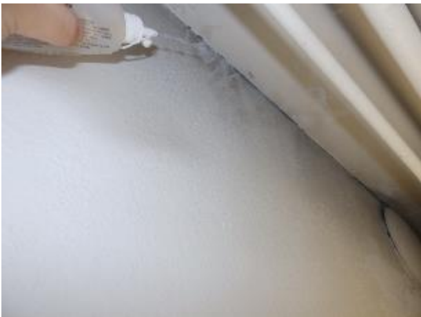
Kuva 41: Wc 008 välipohjasta ilmavirtaus sisätilaan päin. Seinän yläosassa tummia juovamaisia jälkiä, jotka myös viittaavat ilmavirtaukseen rakenteesta huoneeseen päin.
