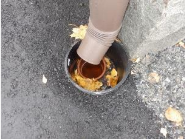
Kuva 66: Sadevesiä ei ole ohjattu suoraan viemäriin. Viemärit ovat auki yläpäästä, josta puunlehdet ja muut roskat pääsevät tukkimaan järjestelmää.
