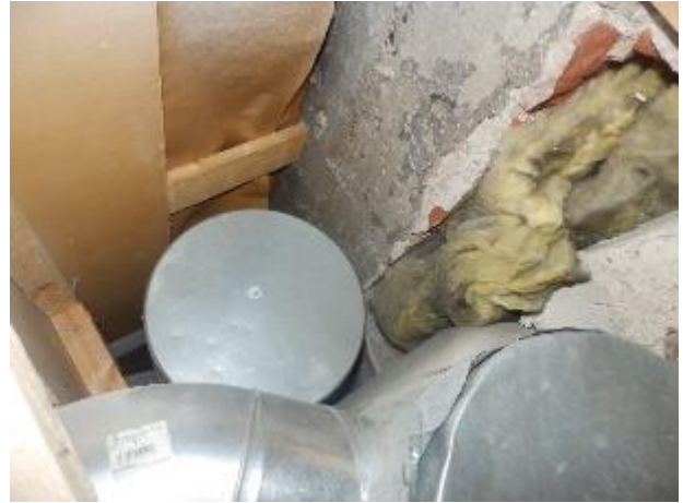
Kuva 48: Bänditila 7 ilmanvaihtokotelon sisällä tummuneita villaeristeistä.
