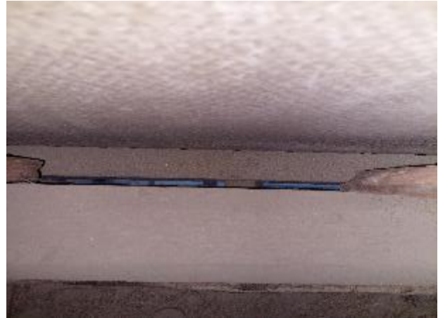
Kuva 58: Kuvassa on otettu yläpohjassa olevan paneloinnissa olevan puuttuvan laudan kohdan kautta alaspäin. Pieni ilmarako on räystäään kohdalla ja ilmayhteys paneloinnin takaa avatuista kohdista yläpohjaan. Ilmareiteissä ei ole pieneläinverkkoja.
