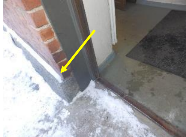
Kuva 18: Kivijalan yläpinta toimii alustana lumelle, joka lisää ulkoseinän alaosan kosteusrasitusta, lumen kastuessa/ sulaaessa.
