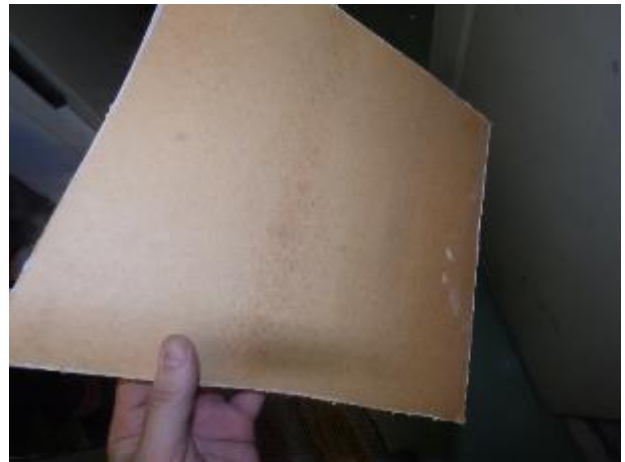
Kuva 50: Bänditila 6 alaslasketun katon kipsilevyn takapinnassa on tummumista.
