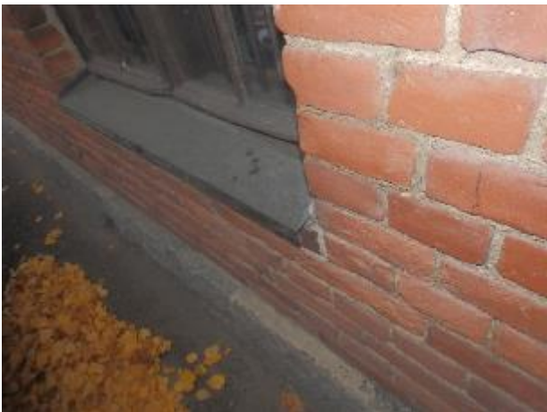
Kuva 19: Ikkunapellityksessä osassa ikkunoita kaato puutteellinen (kuvassa ikkunapelti lähes vaakatasossa), useammassa ikkunassa kaato on kunnossa. Kuvattu kohdekäynnillä 26.10.2022
