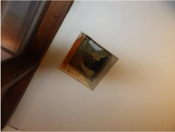
Kuva 31: Wc:n katossa on rakennuslevy, muovitettu paperi ja noin 300 mm mineraalivillaa. Villaeristeen muovipakkauksia osittain jätetty rakenteeseen.
