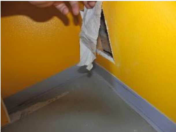
Kuva 15: Tarkkaamotilasta ulkoseinän levytyksen takaa voimakas ilmavirtaus sisälle rakenneavauskohdasta. Paperi pysyy ilmavirrasta selkeästi irti seinän pinnasta. Avauskohta on ulkonurkassa.
