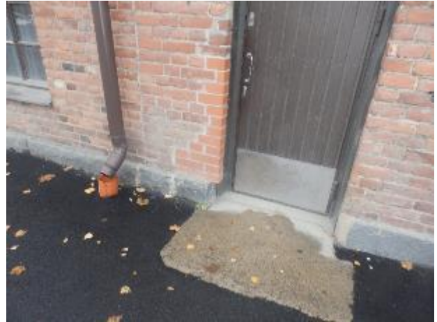
Kuva 63: Hannes Kolehmainen kadun puoleinen sisäänkäynti. Betoniluiska on asfalttipintaa alempana. Sadevesiä ei ole ohjattu kunnolla katolta viemäriin.
