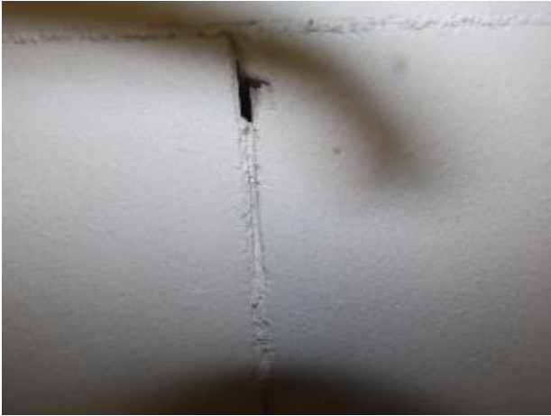
Kuva 39: Muurattujen väliseinien saumoissa on reikiä ja rakoja, välissä mineraalivillaeristys. Rikkonaisista saumoista ilmayhteys eristetilasta huoneilmaan.
