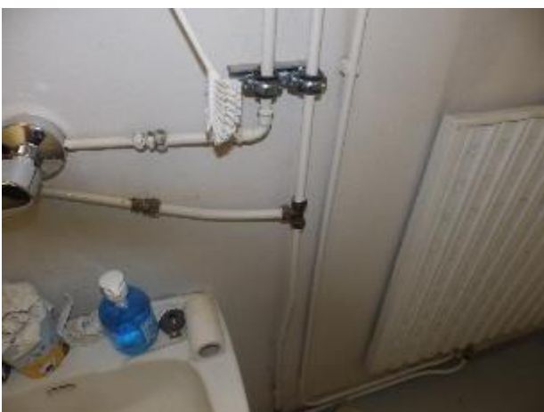
Kuva 69: Käyttövesiputket on kuparilla pinta-asennuksena, ei vuotoja. Kuparisten käyttövesiputkien tekninen käyttöikä on n. 30-50 vuotta. Kupariputkien uusiminen tulee yleensä ajankohtaiseksi, kun vuotoja alkaa ilmetä järjestelmässä tai käyttöikä on lopussa.
