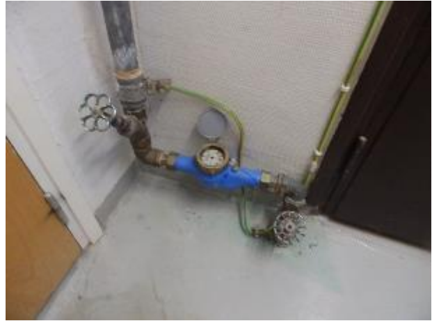
Kuva 92: Vesimittari aistinvaraisesti kunnossa, ei vuotoja.
