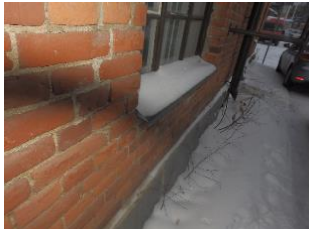
Kuva 20: Ikkunapeltien päälle pääsee kertymään talviaikaan lunta, jonka pinta ikkunan puuosien tasalla, sulaaessa tai lumen kastuessa/ sulaaessa kastelee ikkunarakenteita.
