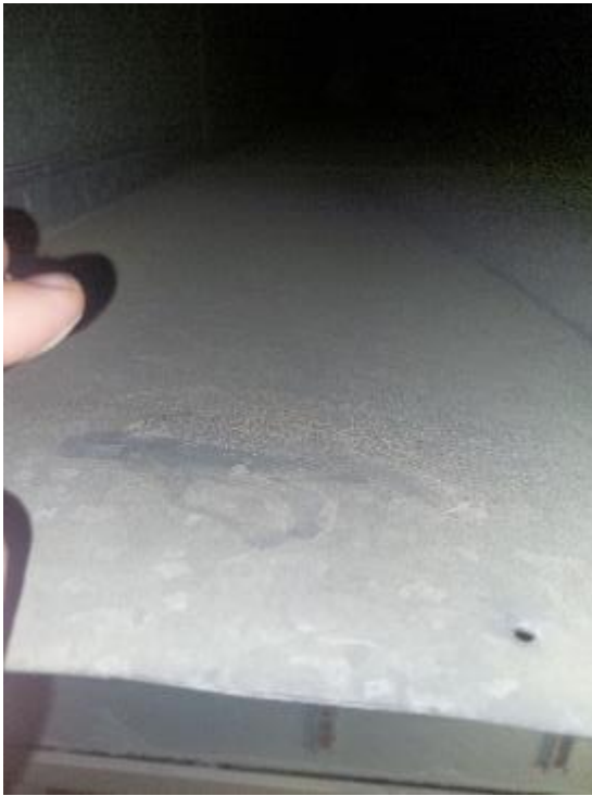
Kuva 71: Tuloilmakanavistossa on paikallisesti reilusti pölyä arvio yli 3 g/cm 2 . Kuvattu eteisaulan kohdalta tuloilmakanavistosta avatun luukun kautta. Muissa tarkastuspisteissä ei yhtä paljon pölyä havaittu.
