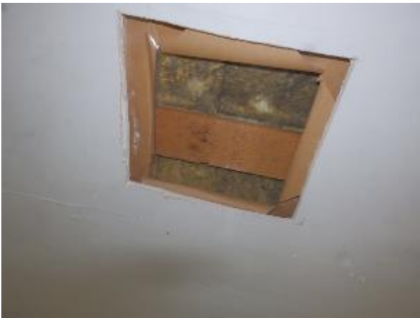
Kuva 49: Bänditila 6 alaslasketun katon päällä on tummuneita villaeristeitä. Kipsilevyn päällä muovitettu paperi, ei ole tiivistetty seinän vierustoilla.
