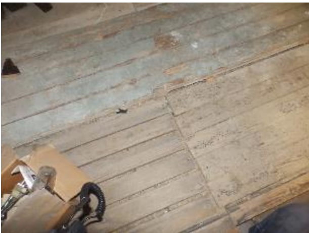
Kuva 84: Otettiin välipohjasta materiaalinäyte harvalaudoituksen alta. Eristeillä ilmayhteys tilan huoneilmaan. Tilasta luukku alapuolella oleviin tiloihin ei ole tiivis.
