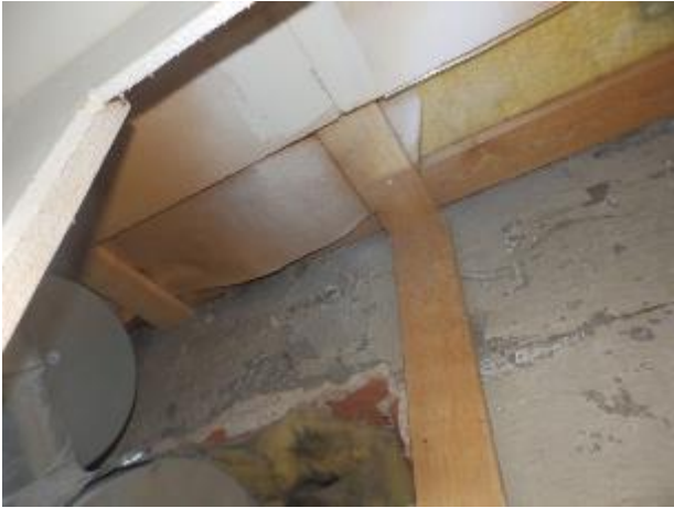
Kuva 47: Bänditila 7 ilmanvaihtokotelon sisällä alakaton päällä olevat villaeristeet ovat näkyvillä, muovitettu paperi näkyy kuvassa ylhäällä, paperia ei ole teipattu tai tiivistetty muuten.
