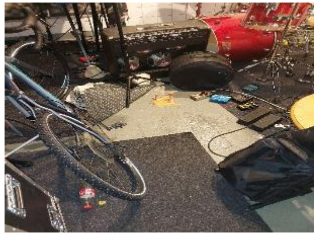
Kuva 42: Tiloissa paljon tavaraa ja pintoja peitetty, joka rajoitti pintarakenteiden kunnon tarkastelua. Näkyvällä osalla ei havaittu halkeamia tai muuta rapautumista sisäpintoissa.
