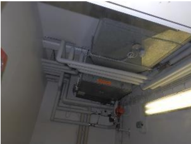
Kuva 68: Rakennuksessa on erillinen tuloilmakone kuvassa ja erilliset poistoilmakoneet katolla. Ilmanvaihtokoneen tarkka ikä ei tiedossa.
