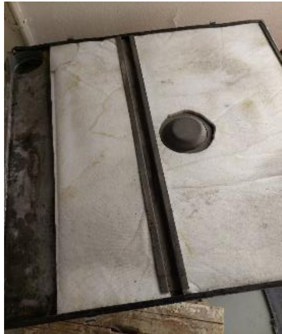
Kuva 74: Tuloilmakoneen pohjalevyn eristeessä kosteuden aiheuttamia jälkiä.
