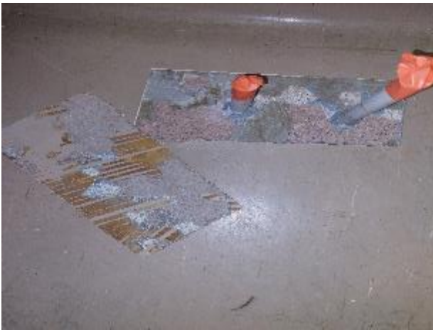
Kuva 3: Betoninmittaus suoritettiin porareikämenetelmällä. Muovimaton tartunta alustaan oli kaikissa tiloissa hyvä, jossa mittaus suoritettiin. (osittain lattian tasoitteet jäivät kiinni maton pohjaan, kuten kuvassa)
