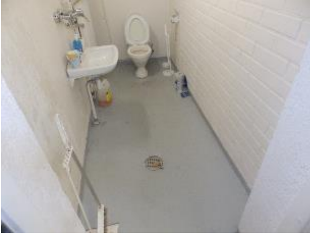
Kuva 87: Tarkastettiin wc-tilat ja muut tilat, jossa lattiakaivo, ei kohonneita pintakosteuslukemia. Wc-tiloissa maalattu betonilattia.
