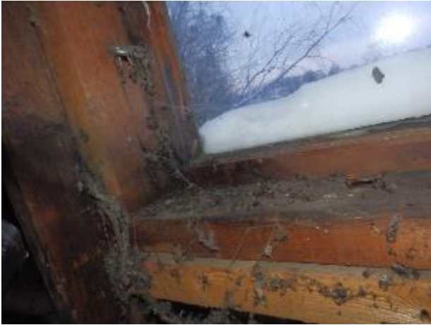
Kuva 21: Yläpohjassa olevan ikkunan puurakenteissa on tummumista, tutkimushetkellä kuivia. Ikkunassa ei havaittu kondenssia tutkimusten aikana (yläpohjan lämpötila lähellä ulkoilmaa, ei merkittäviä lämpövuotoja)
