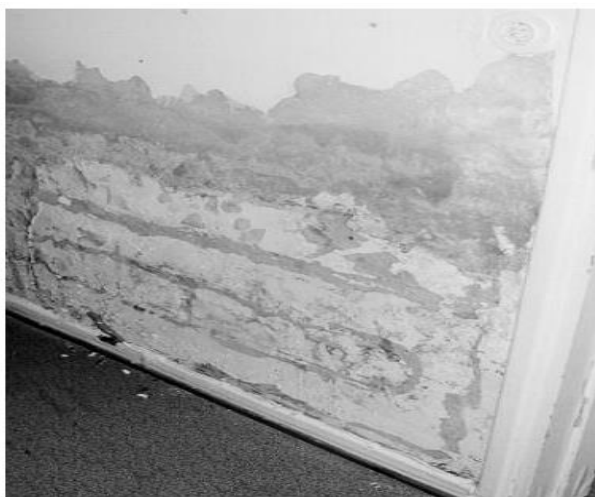
Kuva 2. Kapillaarisen veden siirtymisen aiheuttama pinnoitteen irtoaminen alustasta. (/E. Kauriinvaha, TKK talonrakennustekniikka lab./ www.sisäilmayhdistys.fi terveelliset tilat)
