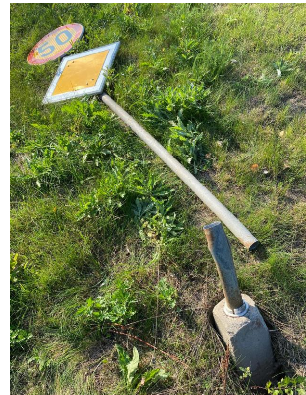
Kuva 2. Vaurioitunut liikennemerkkiputki Hervannassa sattuneen liikenneonnettomuuden jäljiltä. Putki on jouduttu katkaisemaan sahaamalla.
