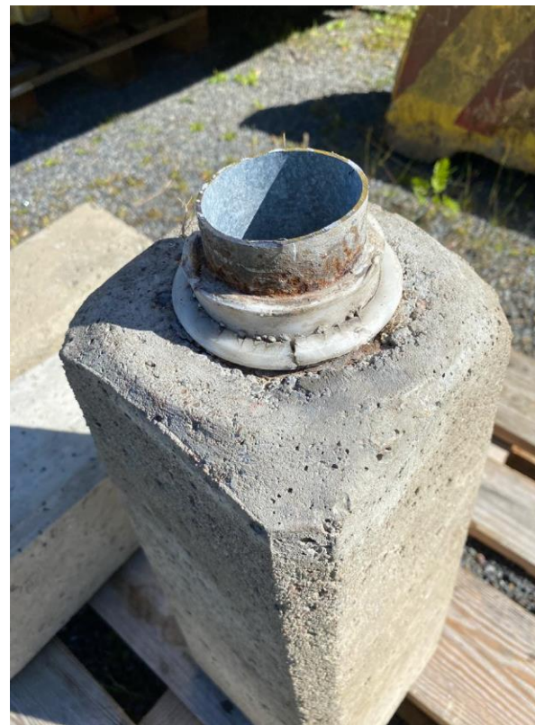
Kuva 1. Ruostunut ja jumiutunut putkenpätkä jalustassa.
