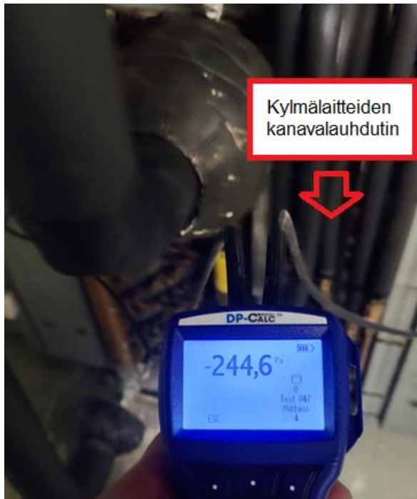
Kuva 11. Lämmöntalteenottopatteri ja kylmäkoneiden kanavalauhdutinpatteri.
