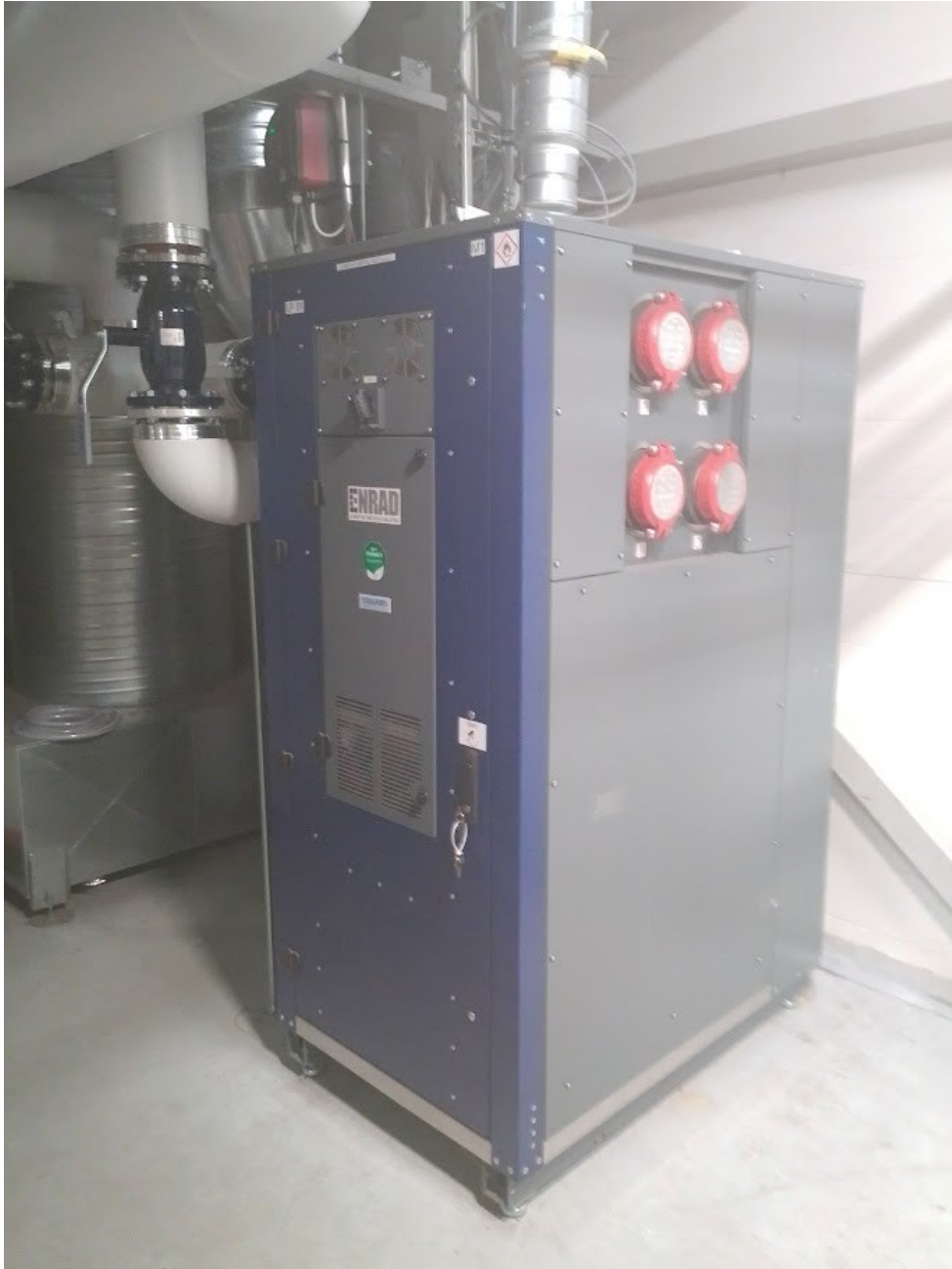
Kuva 14. Lauhdelämpöpumppu, jonka kylmäaineena on propaani.
