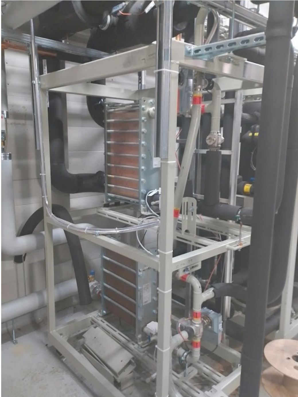
Kuva 3. Konepukin pääty. Ylhäällä alijäähdytin ja alhaalla tulistuksen poistin.
