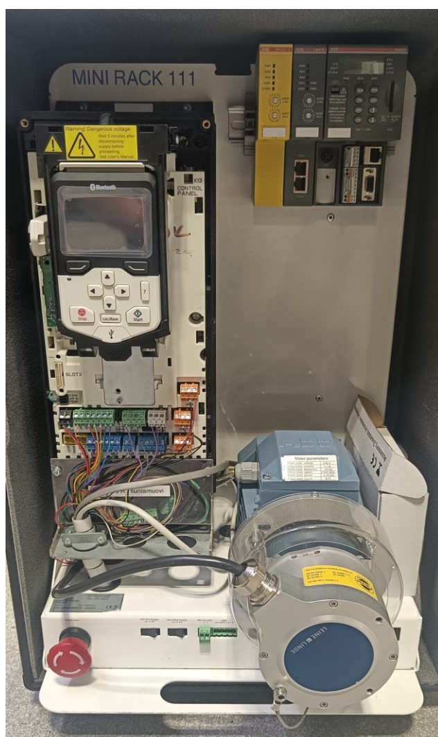
Kuva 10. Demosalkku. kuvassa näkyy AC500-S-logiikkakontrolleri, ACS880-01-taajuusmuuttaja ilman etukuoria ja sähkömoottori, johon on kytketty enkooderi.
