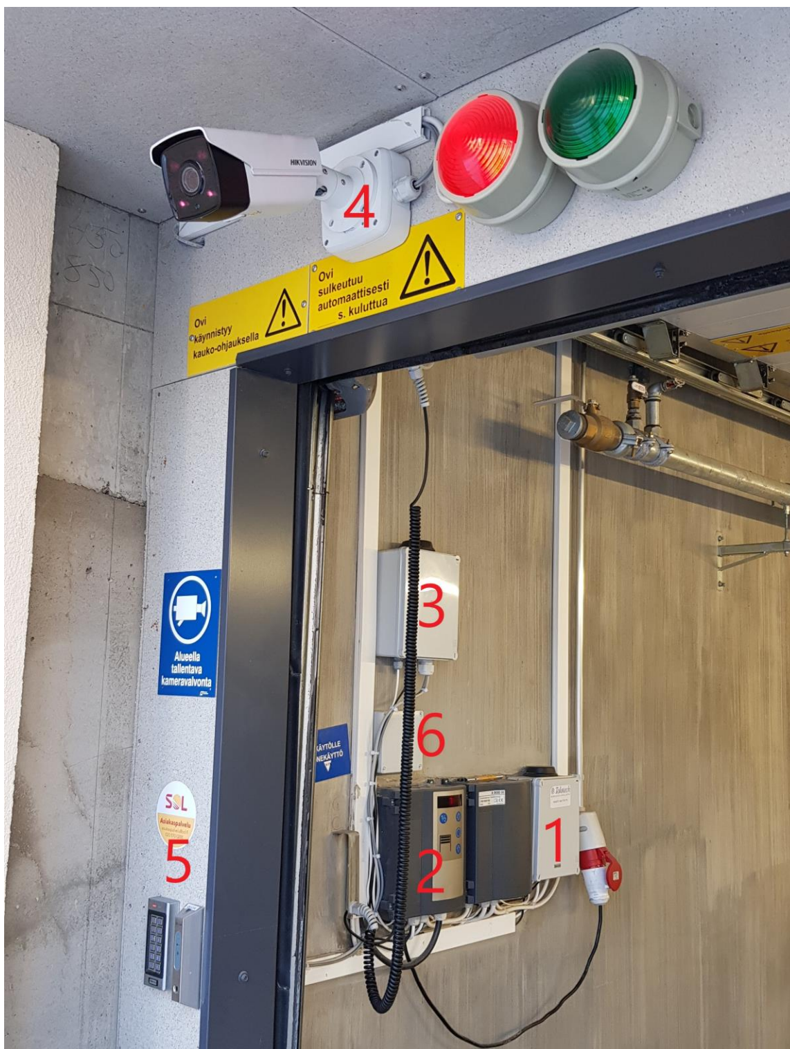
KUVA 1. Erään pysäköintihallin lamellinosto-oven ohjainlaitteet. (Kuva: Veeti Koski 2023)
