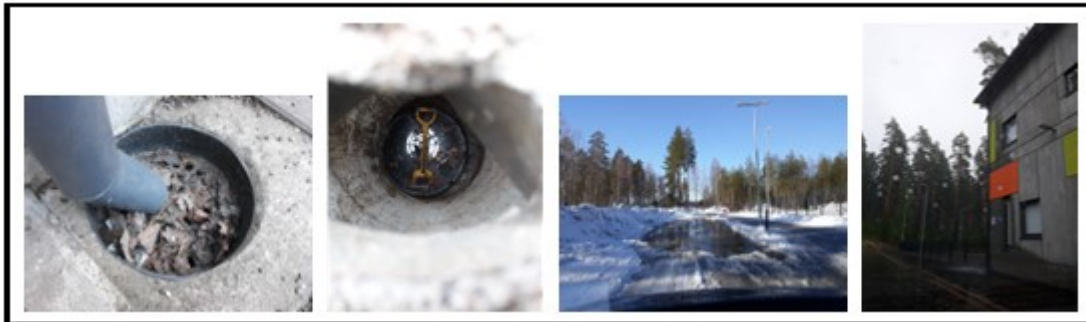
Kuva 5. Sadevesijärjestelmissä esiintyviä yleisiä ongelmia
