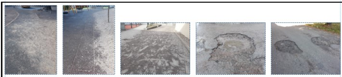
Kuva 1. Puhdistamattomia päällystettyjä alueita ja kuoppia asfaltissa
