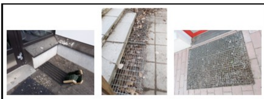
Kuva 2. Irtoainesta ja linnun ulostetta rappurallien alla ja sisäänkäynnin edustalla
