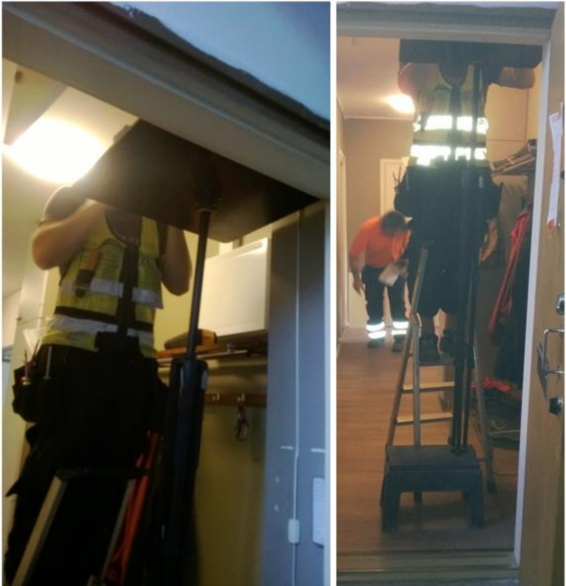
KUVA 1. Liian lyhyt asennusvara
