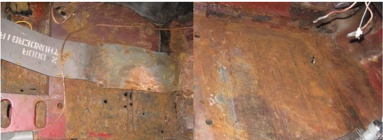
Kuva 54. Lattian ruostevaurioita (Kuvat: Olli Panhelainen).
