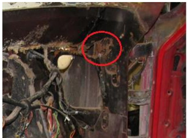
Kuva 13. Ruostevaurio (Kuva: O.P).
