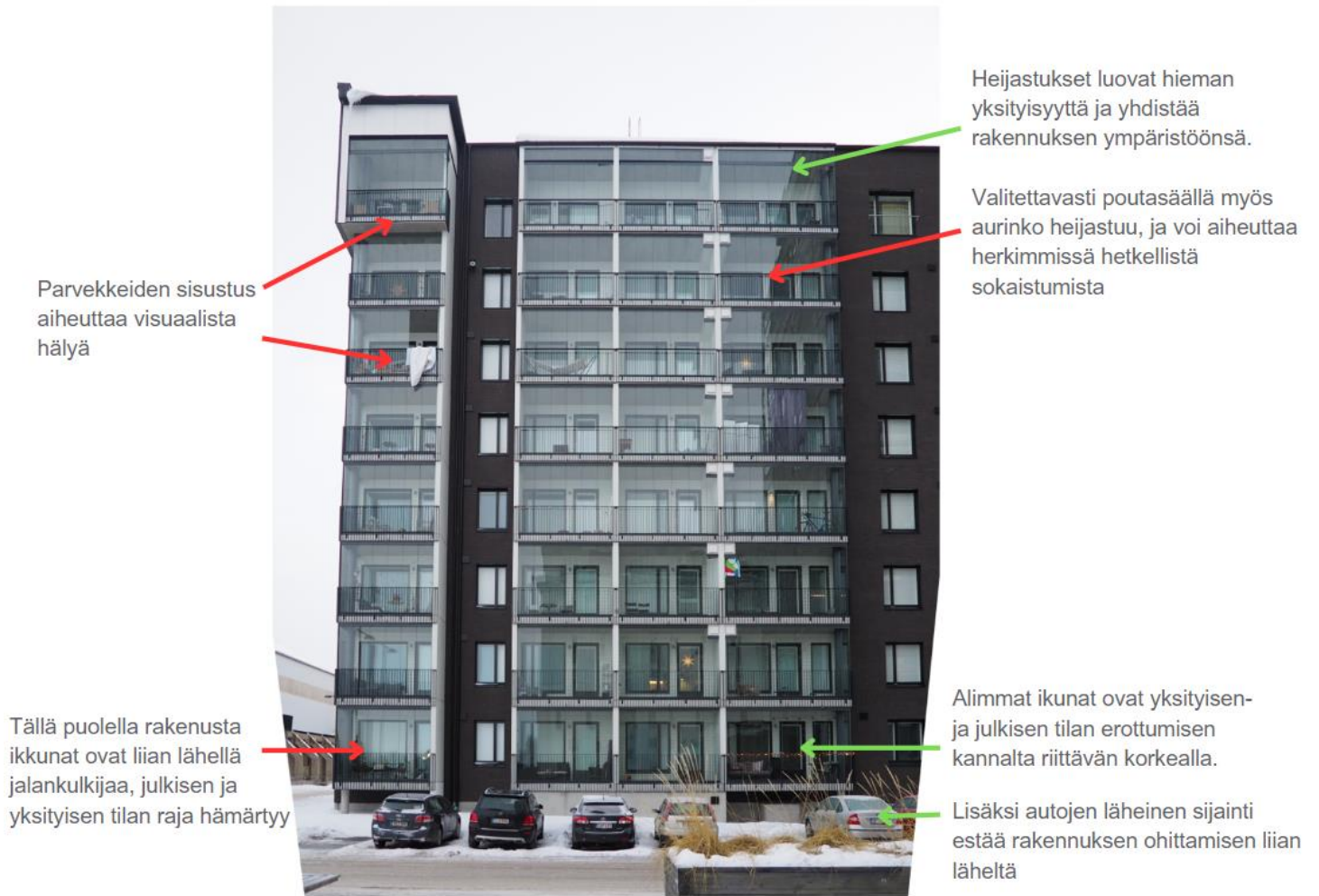
KUVA 35. Läpinäkyvien parvekkaiteiden haittapuolia. Ongelma korostuu kesäisin, jolloin parvekkeita on sisustettu, niillä vietetään eniten aikaa ja parvekelaseja pidetään auki. Siilo-tie 1, Toppilansalmi
