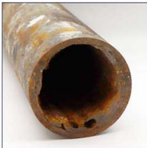
Vanha valurautainen viemäriputki
