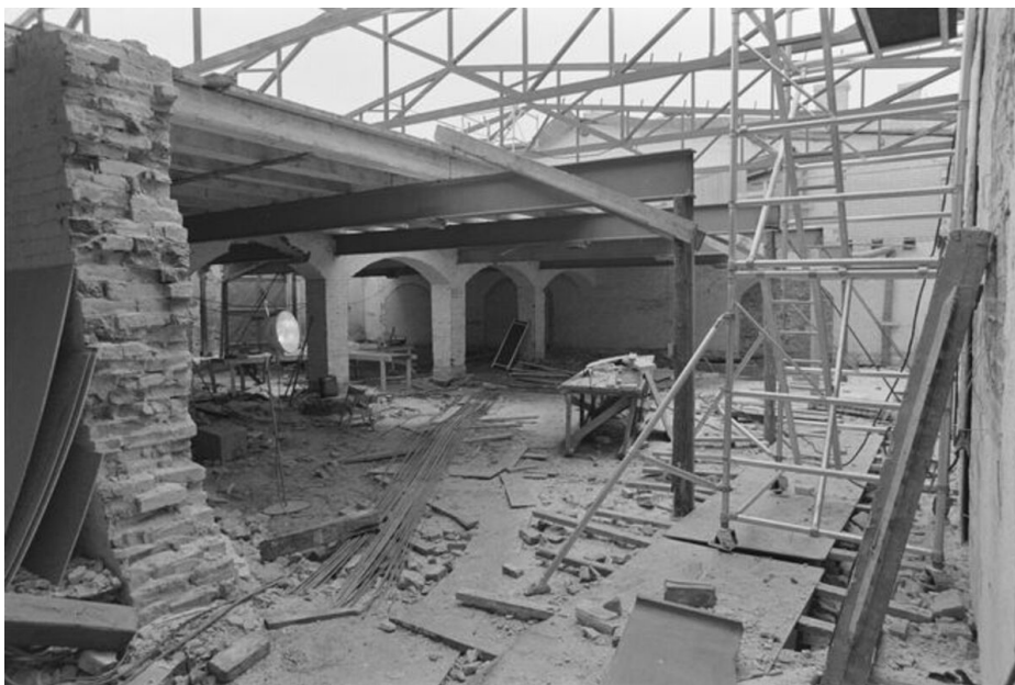
Kuva 10. Kuva Satakunnan museon kuvakokoelmasta näyttelytilan korjauksesta helmikuussa vuonna 1980 (Porkkala, 1980). Vanhan yläpohjarakenteen tilalle asennetaan teräksiset kattoristikot.
