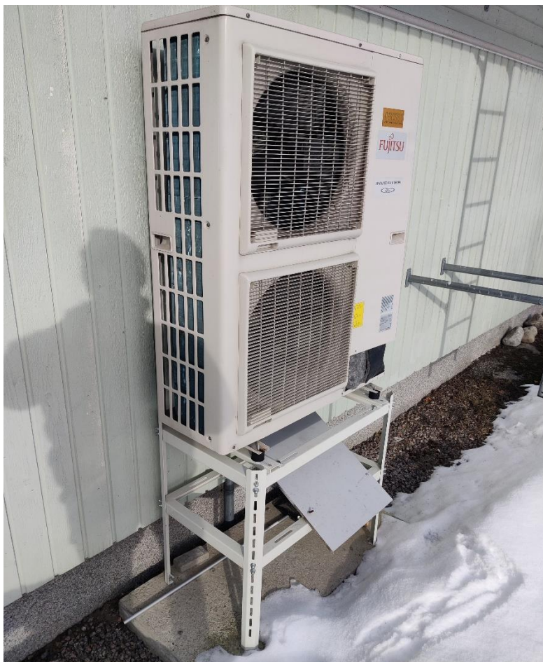
Kuva 1 Vesi- ilmalämpöpumppu ulkoyksikkö (Liukko, 2023)
