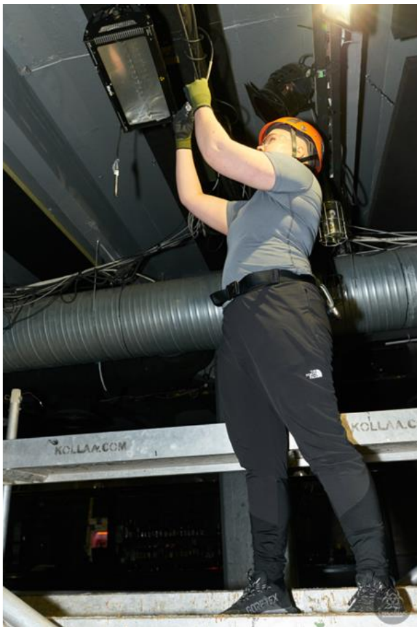
Kuva 6. Työskentely pään yläpuolella
