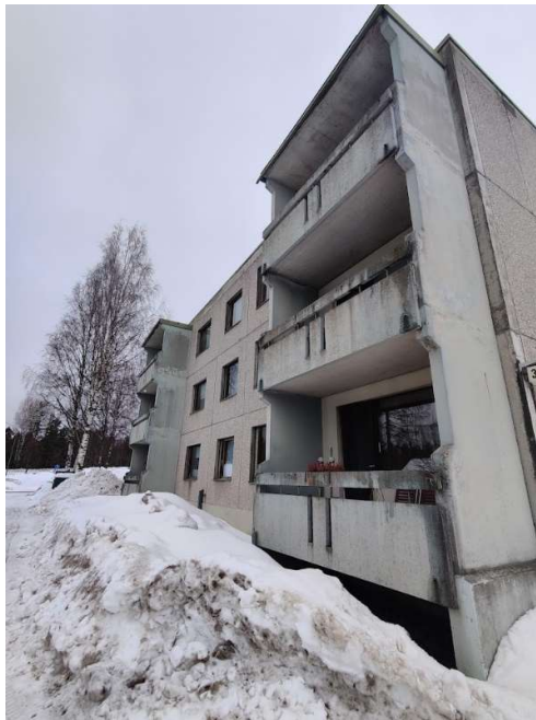
KUVA 16. Parvekkeiden huonontunut kunto
