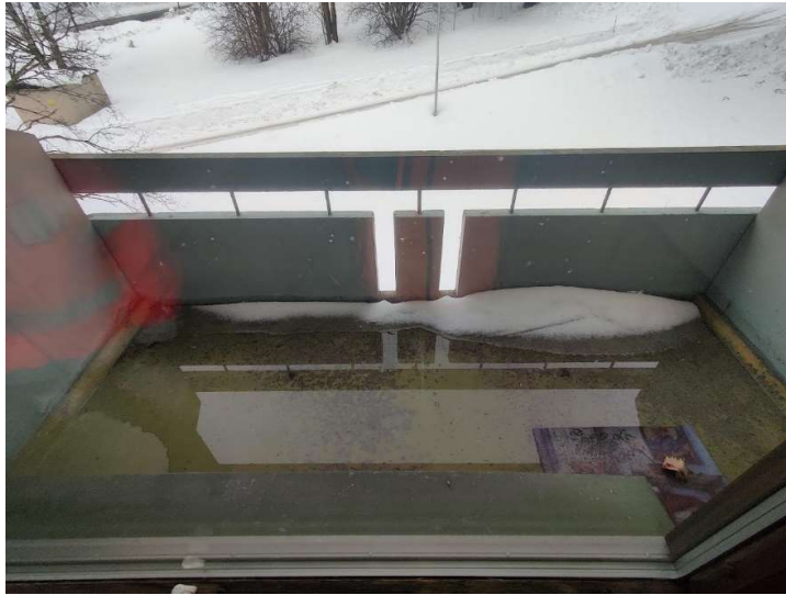
KUVA 18. Vesi ei pääse pois parvekkeelta
