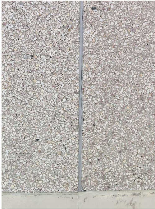
KUVA 11. Elementin sauma halkeillut
