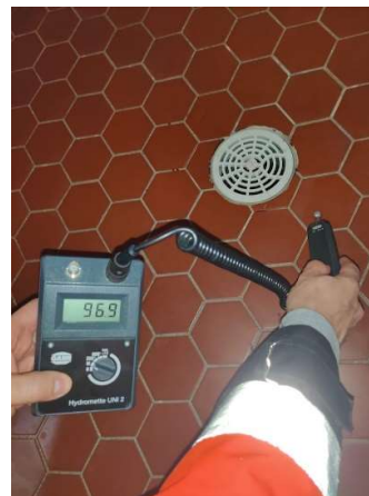
KUVA 28. Kosteusarvo kaivon ympärillä
