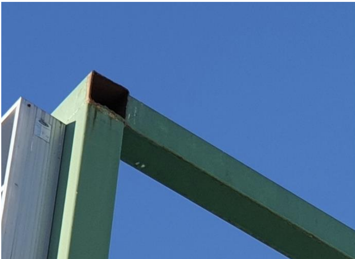
Kuva 21. Teräsrakenteessa ei toivottu ruostetta. [41, s.28]
