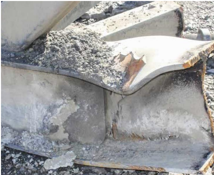
Kuva 22. Tulipalossa kantokykynsä menettänyt teräsrakenne. [45.]
