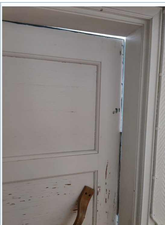
Kuva 12. Ulko-oven yläreunassa ilmenevä rako
