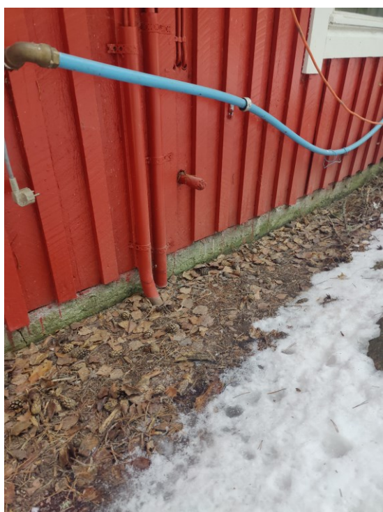
Kuva 7. Ulkoverhouksen ja perustuksien liitoksen puutteellinen ilmarako
