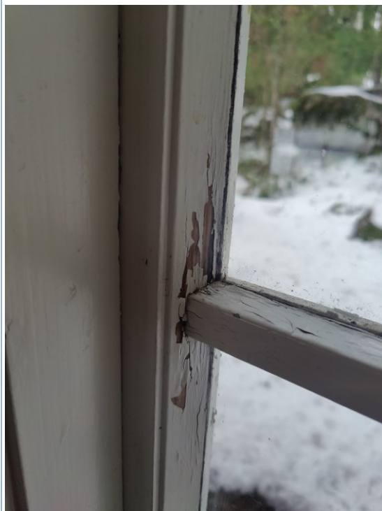
Kuva 10. Ikkunan sisäpuolista vauriota
