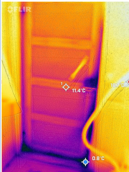
Kuva 17. Tuvan ulko-ovi, lämpökuva
