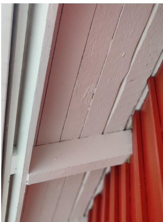
Kuva 8. Räystäslaudoituksen puutteellisesta ilmaraosta
