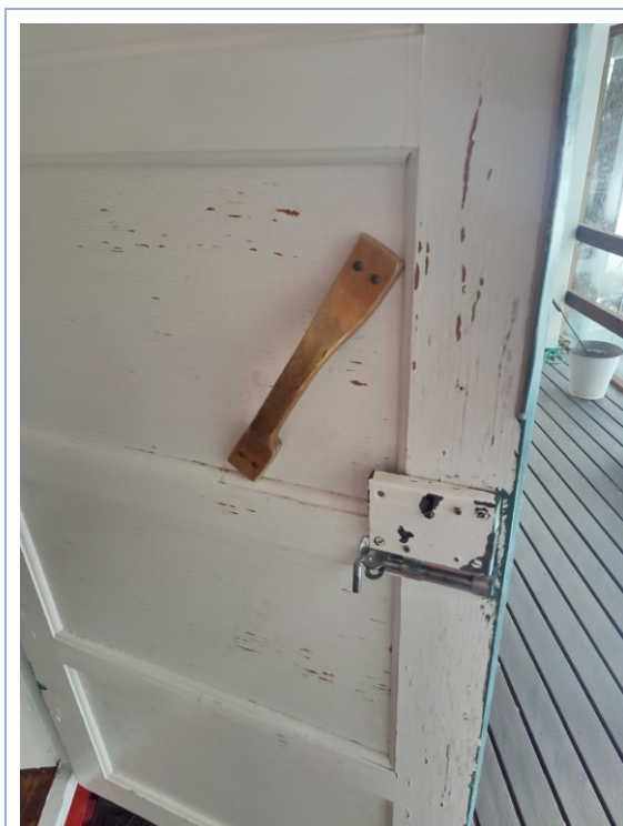
Kuva 11. Ulko-oven sisäpuoleiset vauriot
