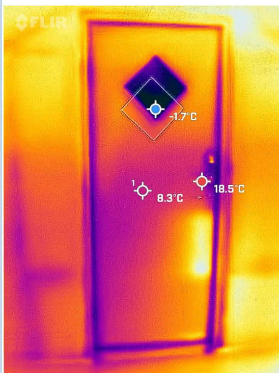
Kuva 23. Yläkerran uusi ulko-ovi, lämpökuva
