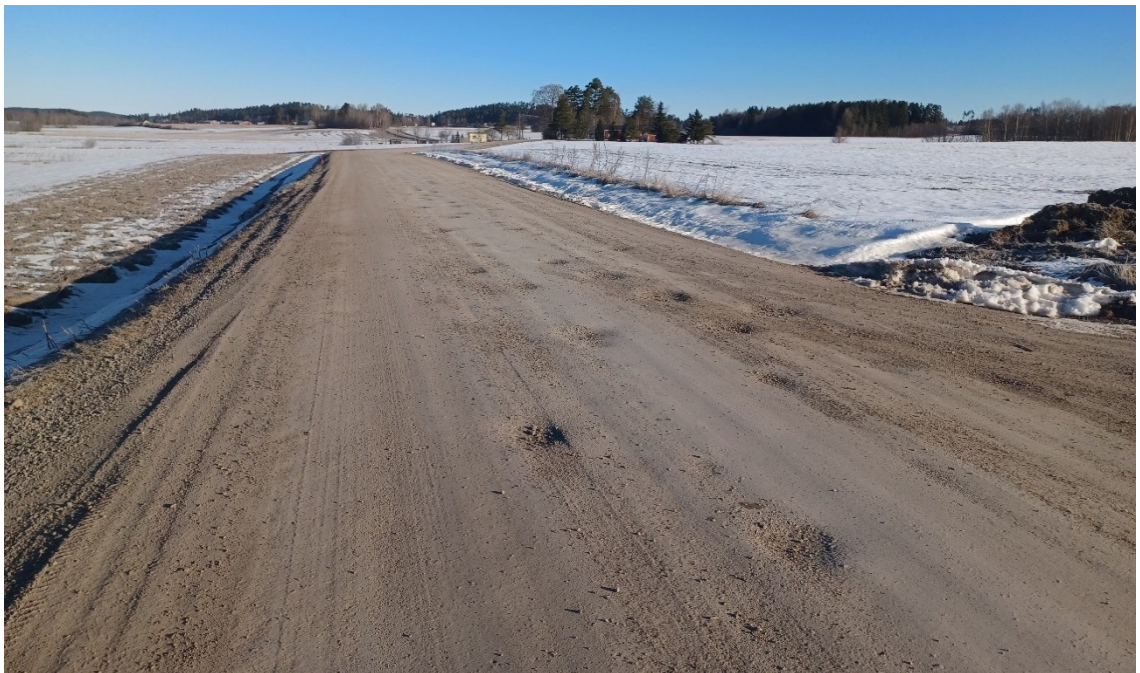
Kuva 26. Koeosiolla havaittavissa reikäsarjoja (Rautalin 2023)
