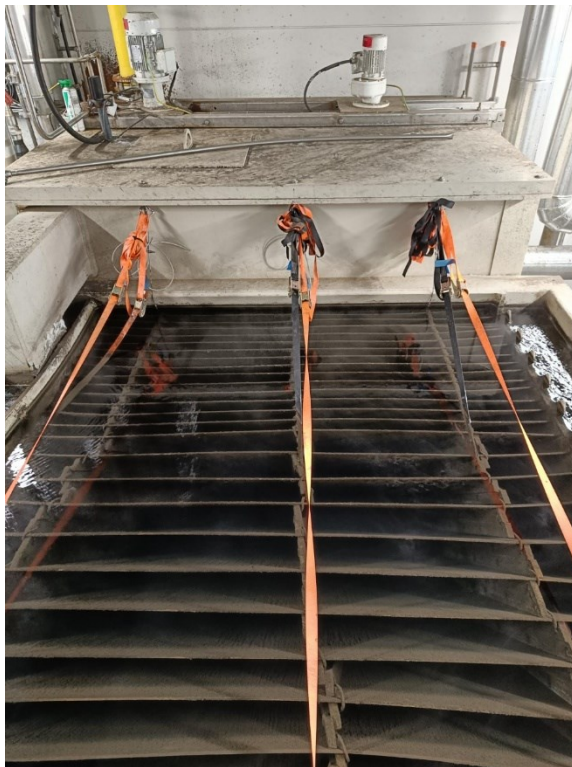
Kuva 16. Lamelliselkeytin optimoinnin jälkeen.
