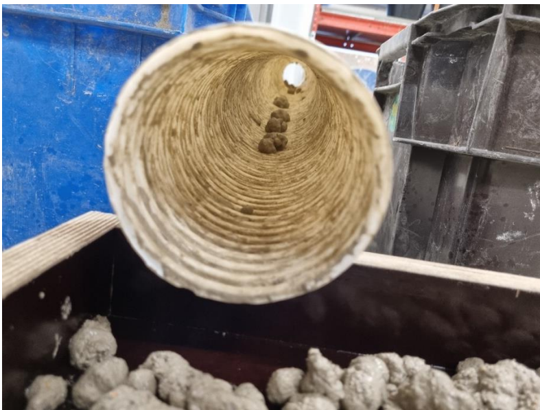
Kuva 19. Peltosalaojaputken epätasainen sisäpinta
