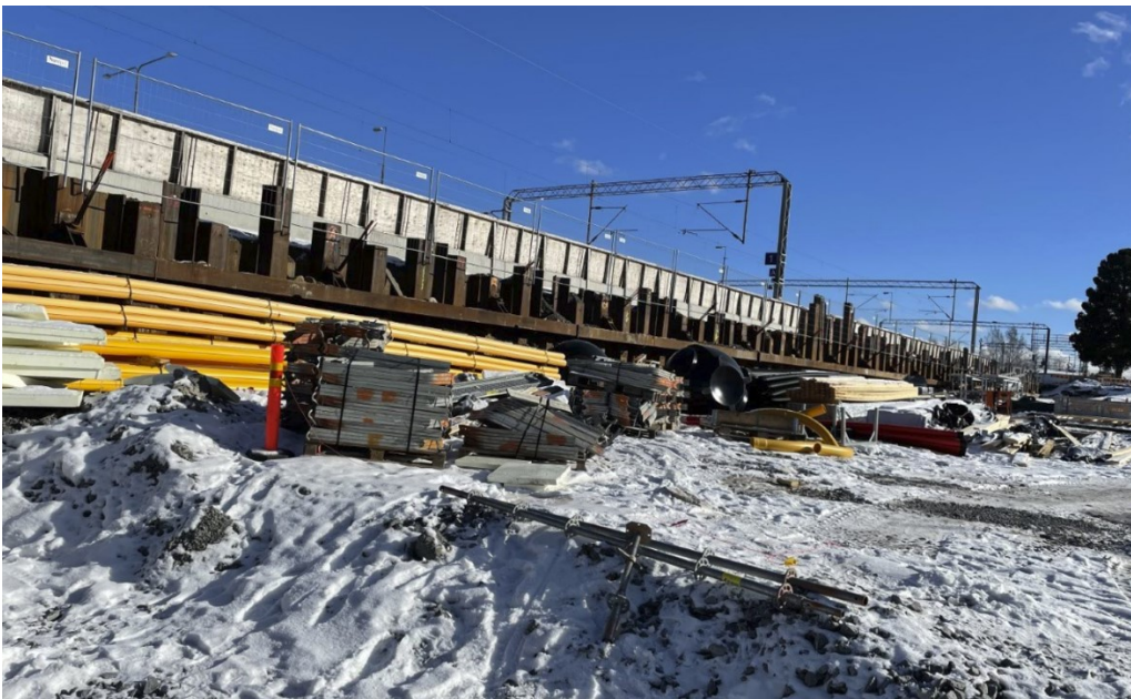
Kuva 6. Pysäköintitalon pohjalle tullut varasto
