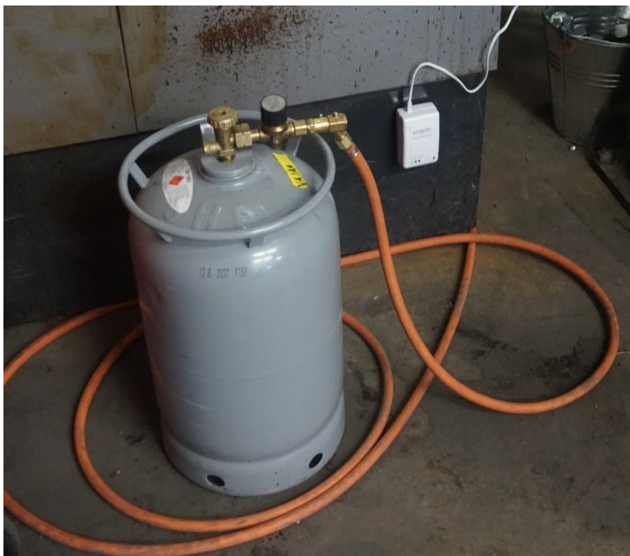
KUVA 7. Kaasupullo ja toinen kaasuvaroittimista (Hämäläinen, 2023)
