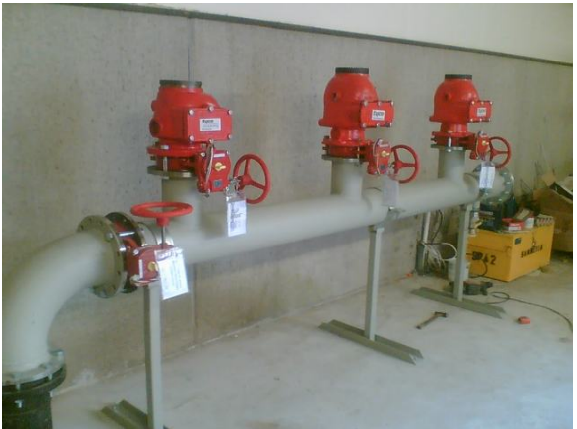
Kuva 1. Tulojohto ja hälytysventtiilit.
