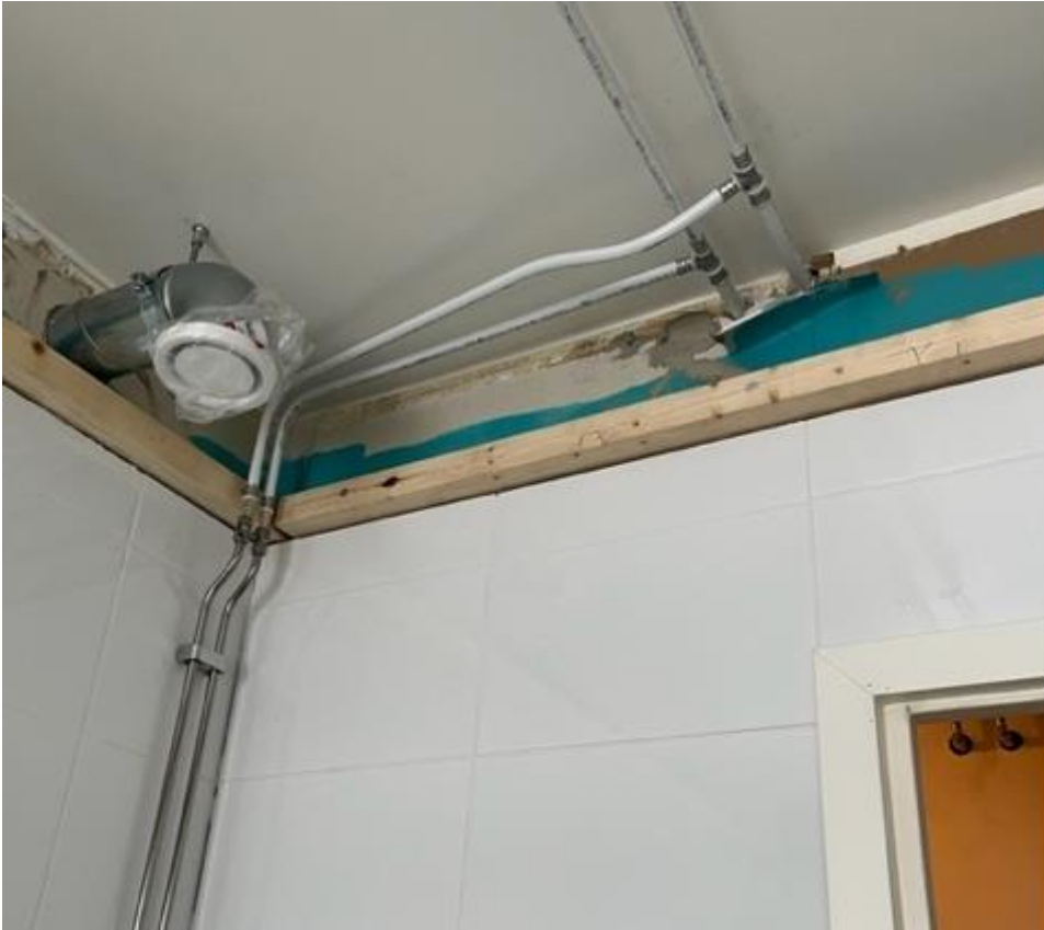
KUVA 15. Alakoton sisälle mahdutettavaa tekniikkaa
