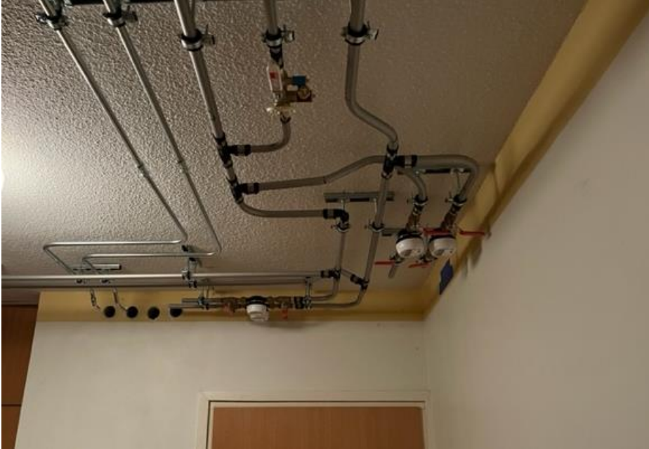
KUVA 2. Vesimittareiden sijoitus porrashuoneessa
