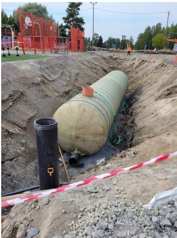
Kuva 18, hulevesien viivästysäiliö (Anette 2022)
