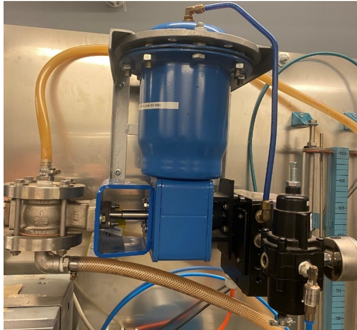
Kuva 15. Pinnankorkeuden säätöventtiili ja asennoitin.
