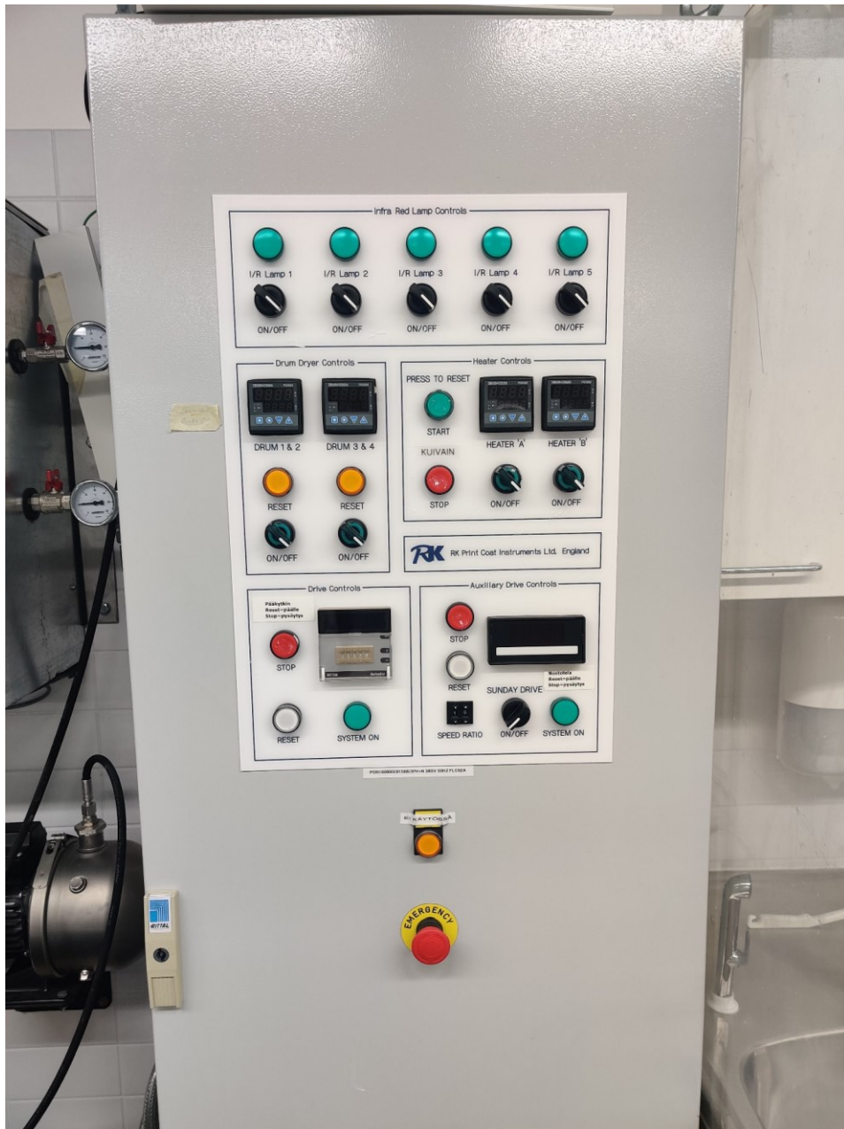
KUVA 3. Sähkökaappi ja sen ohjaimet.
